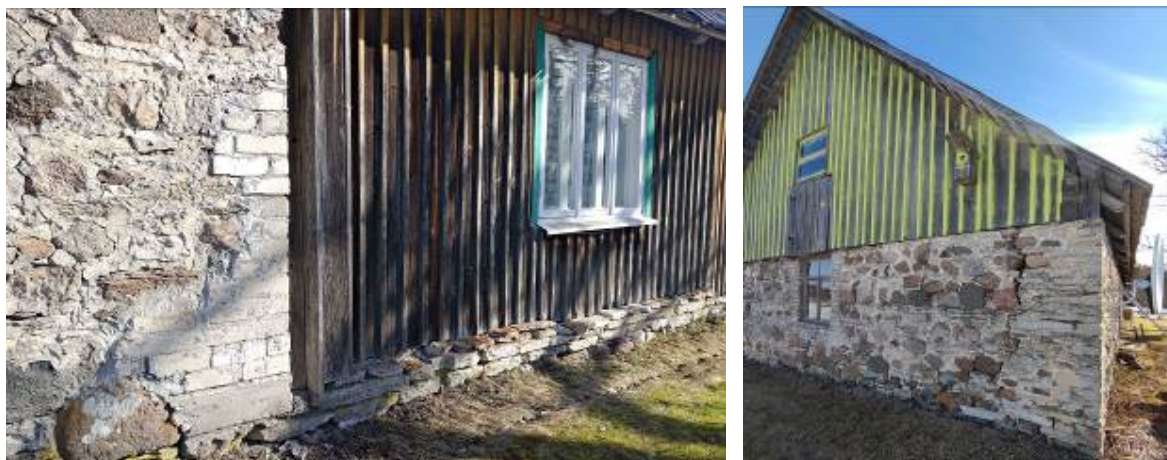
33. Silikaattelistega parandatud müüritis hoone lõunaseinas. 27.03.2022. Foto: T. Väikmeri.
