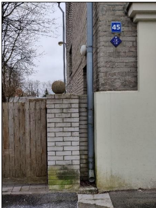
Illustratsioon 27. Esifassaadi sokli ja väravaposti veekahjustus 2022. aasta märtsis (autori pilt)
