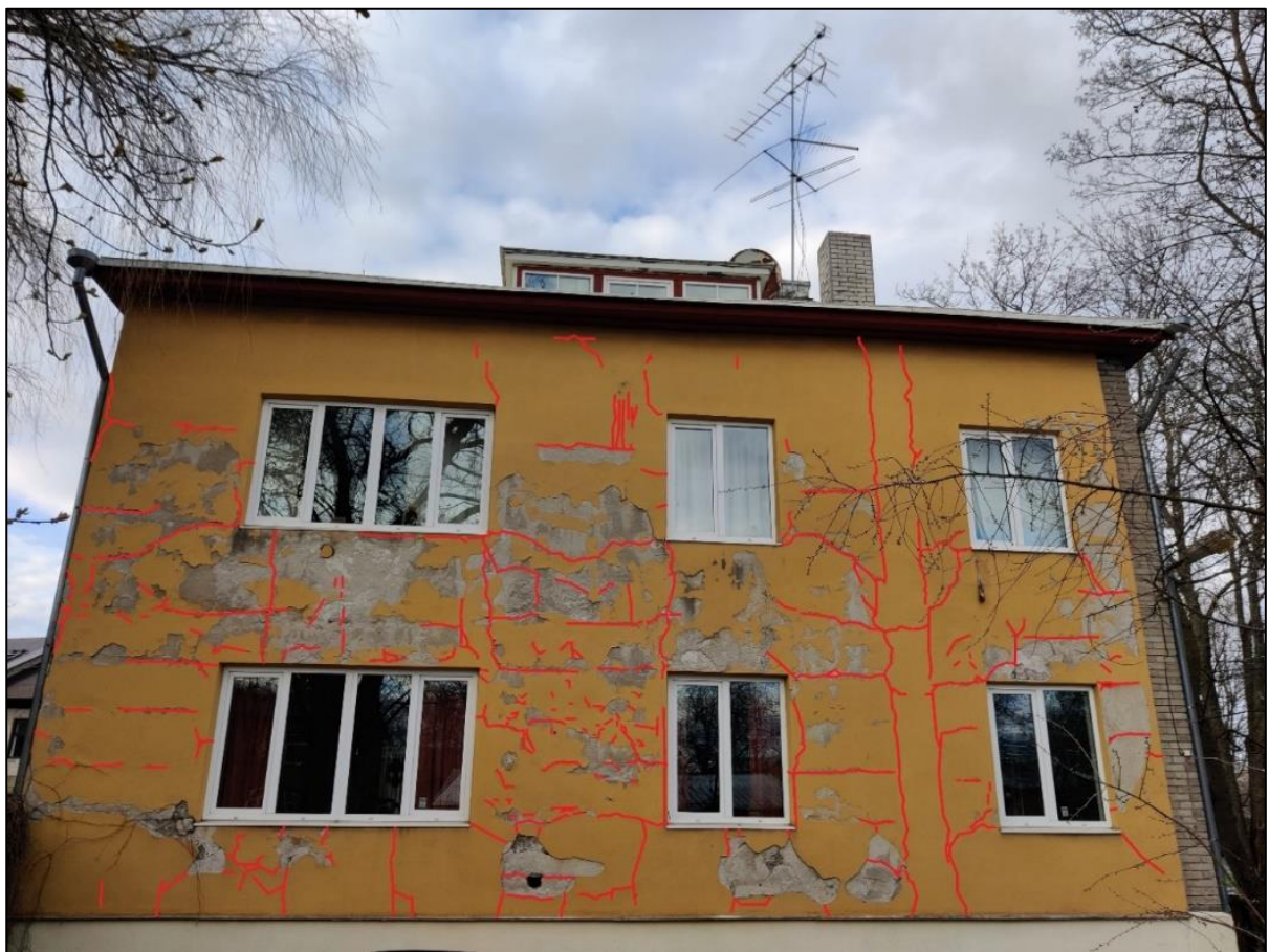
Illustratsioon 34. Pääksepoolse fassaadi kahjustuste kaardistamine (autori pilt ning visandatud jooned)
