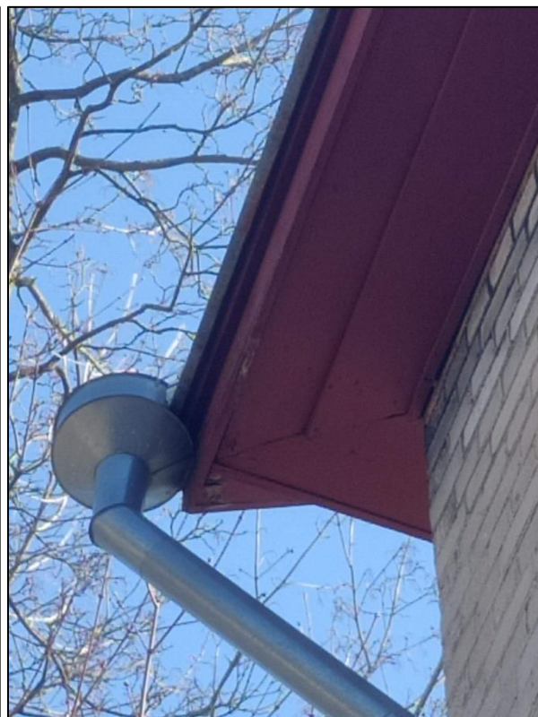
Illustratsioon 37. Ida- ning põhjapoolse fassaadi nurga räästakasti kahjustus 2022. aasta märtsis (autori pilt)
