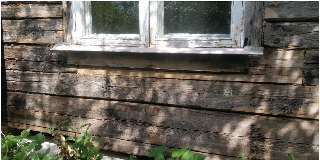
Pilt 24. Tõenäoliselt veekahjustusest tingitud aknaaluse palgi asendamine laudadega 08.2022 (allikas: Autor)
