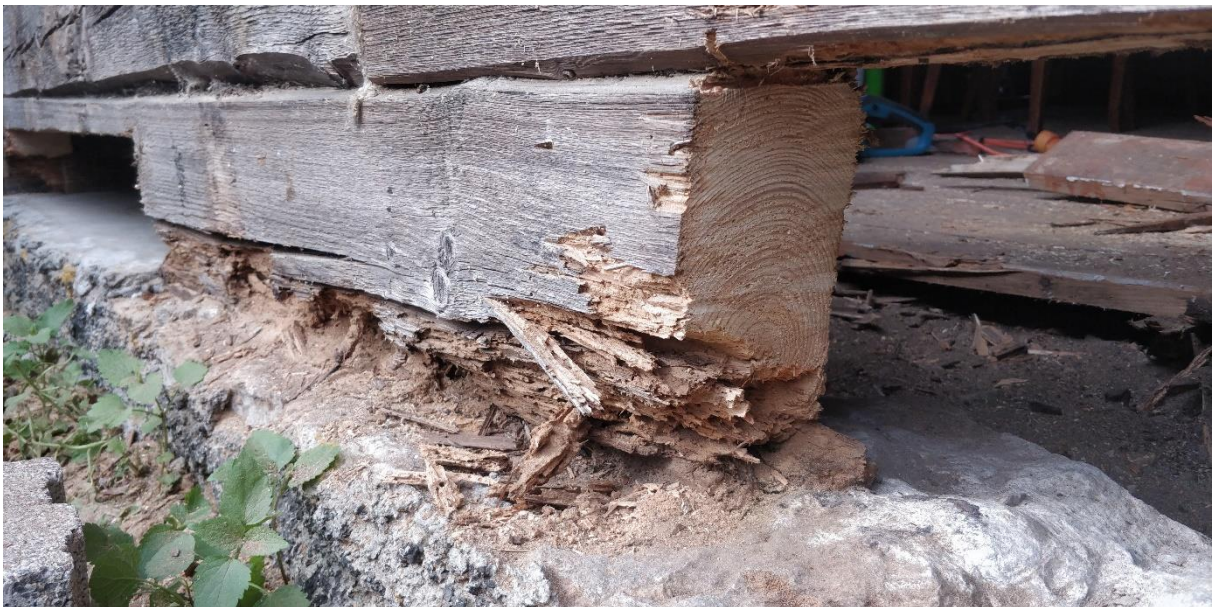
Pilt 11. „Pehkinud“ alumine palk vundamendi ja välisseina liitekohas 08.2021 (allikas: Autor)
