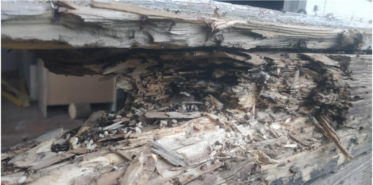
Pilt 18. Sipelgapesa lõunapoolses välisseinas, kahjustuse ulatus on läbi terve palkseina poole palgi ulatuses 08.2021 (allikas: Autor)
