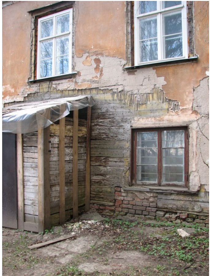
Foto nr.21 Sadevetest kahjustatud sein
