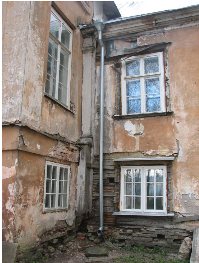
Foto nr. 22 Katuse neelukohal lagunenud sein.
