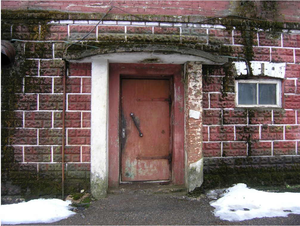
Põhjapoolse tehasehoone „paraadna”. Ilmekalt on näha veepritsmetest põhjustatud niiskuskahjustused. Märts 2007 (P.Roosalu)
