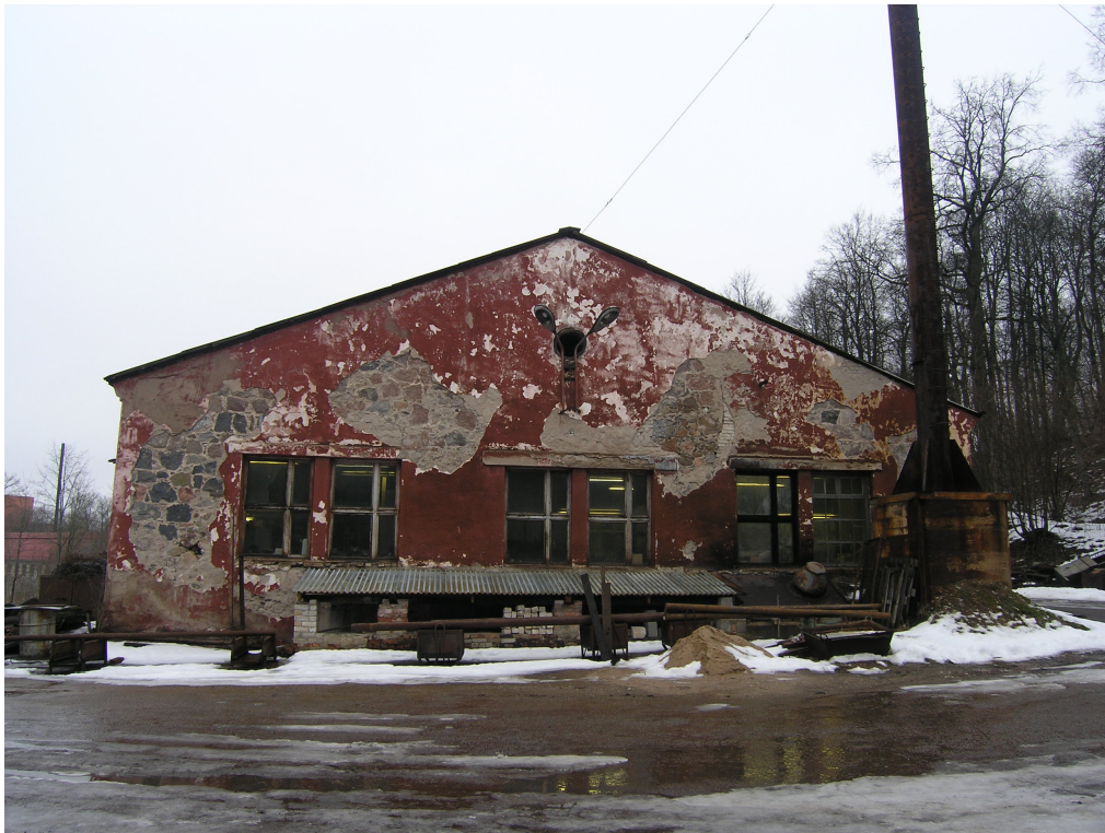
Vaade lõunapoolse hoone lõunafassaadile. Krohvi alt on paljastunud I ehitusetappi maakivimüürid. Paremases nurgas on säilinud originaaljaotusega aknaraam. (M.Roosalu)
