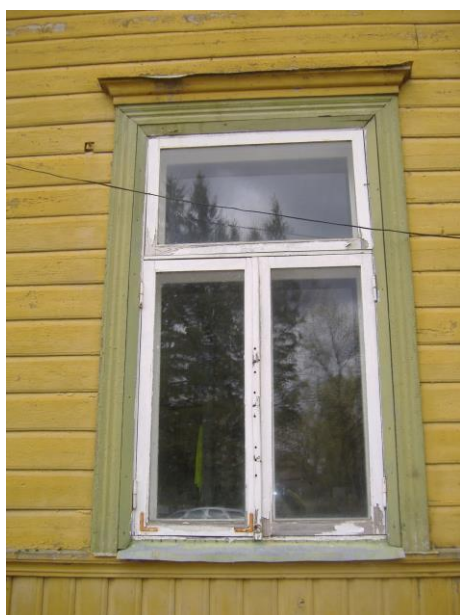
Foto nr 19. Puitaken profileeritud aknapiiretega otsaseinas.
