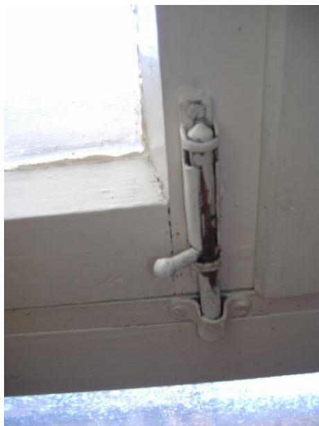
Foto nr 27. Akendel on säilinud metallidetailid.
