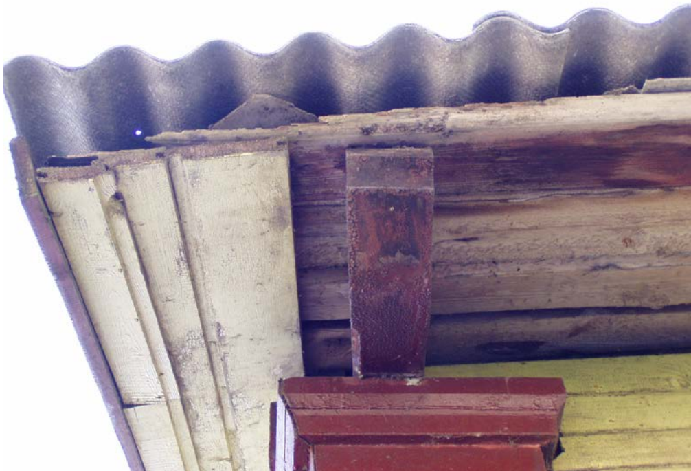
Foto 12. Lagunenud räästalauad. Katusekatte alt paistab eelmise eterniitkatte tükke.
