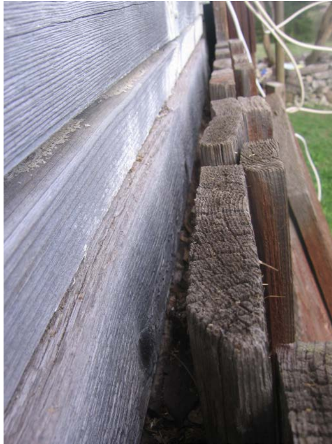
Pilt 11. Aknaraam ja ava juures katkestatud välisvooder on ilmastiku mõjudele avatud.
