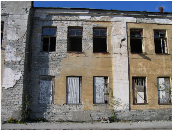
18. Veekahjustustest põhjustatud krohvivaringud esifassaadil ning puuduvad ja katkised aknad
