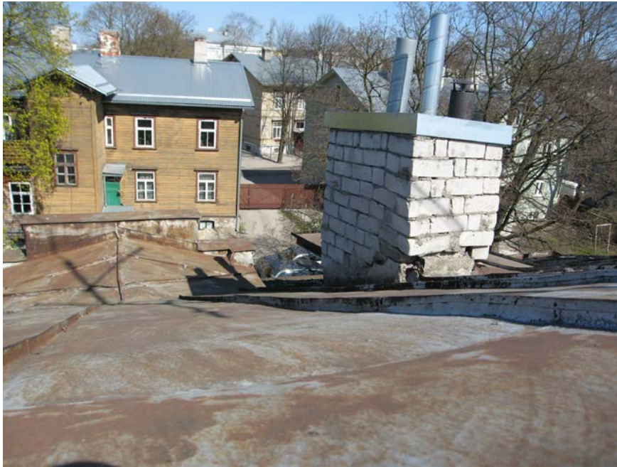
Foto 39. Vajunud ja pragudega uus korsten. Foto: Erja-Liina Raidma 2008.
