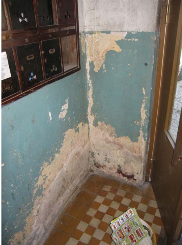
Foto 44. Trepikoja seina soolakahjustused. Foto: Erja-Liina Raidma 2008.
