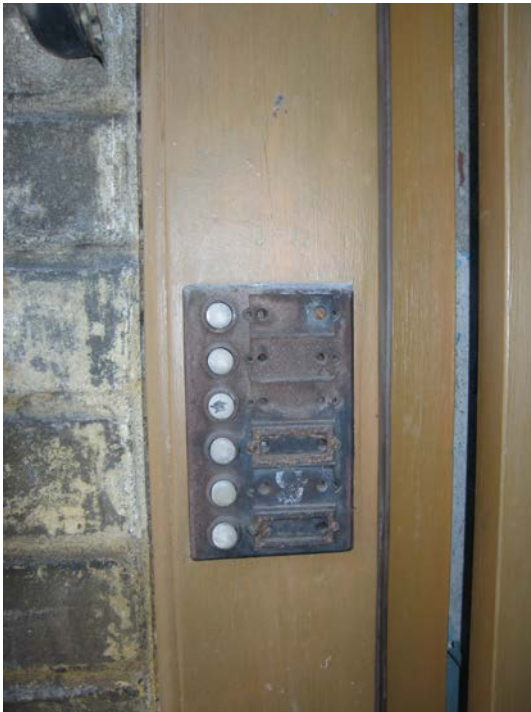
Foto 23. Hoovihoone välisukse kellenuppude ja nimesiltide paneel. Foto: Erja-Liina Raidma 2008.
