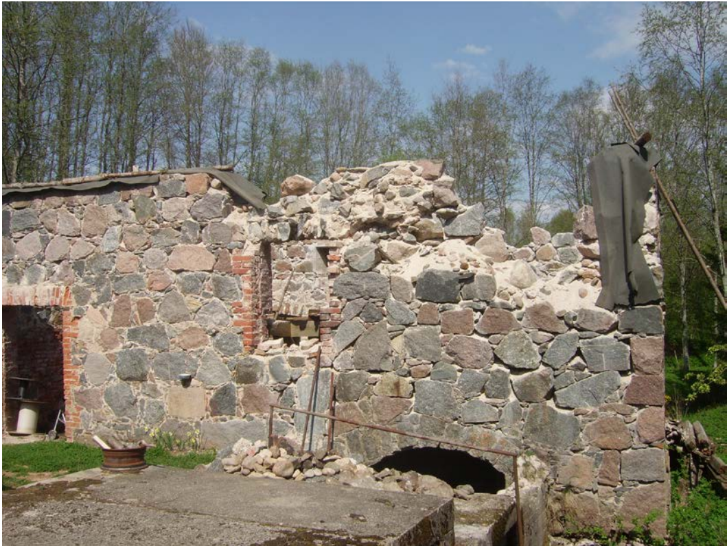
Foto nr. 7 Kahjustatud seiniosa edelapoolsel fassaadil
