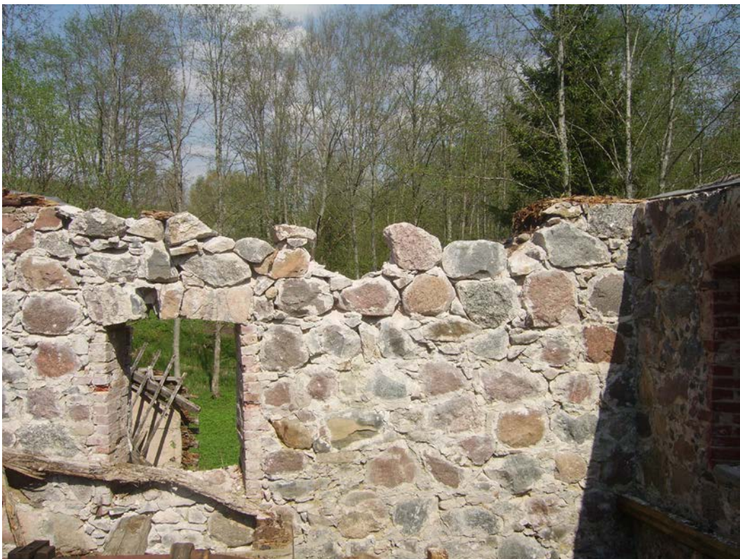
Foto nr. 8 Kahjustatud seiniosa kirdepoolsel fassaadil
