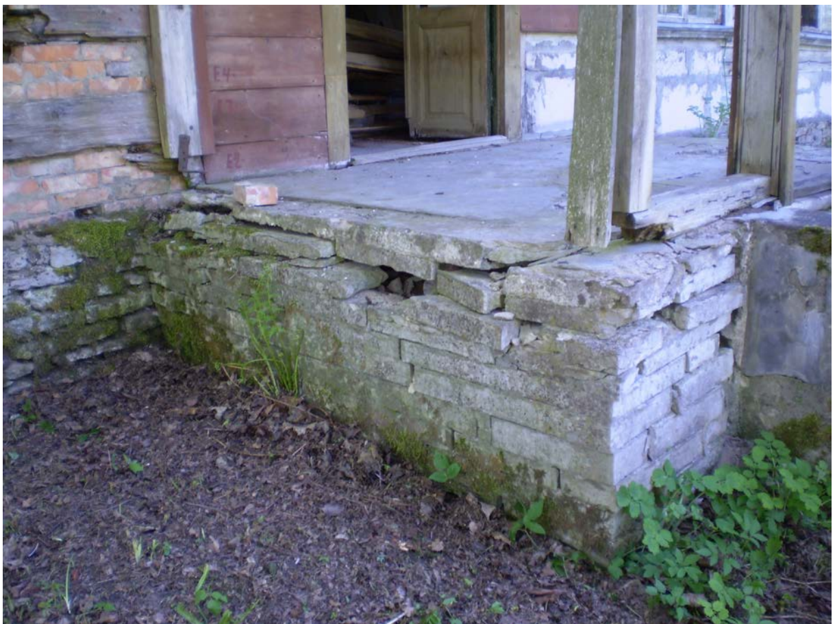
Foto nr.22 Vundamendi kahjustused härrastemaja pargipoolse palkoni vundamendil.
