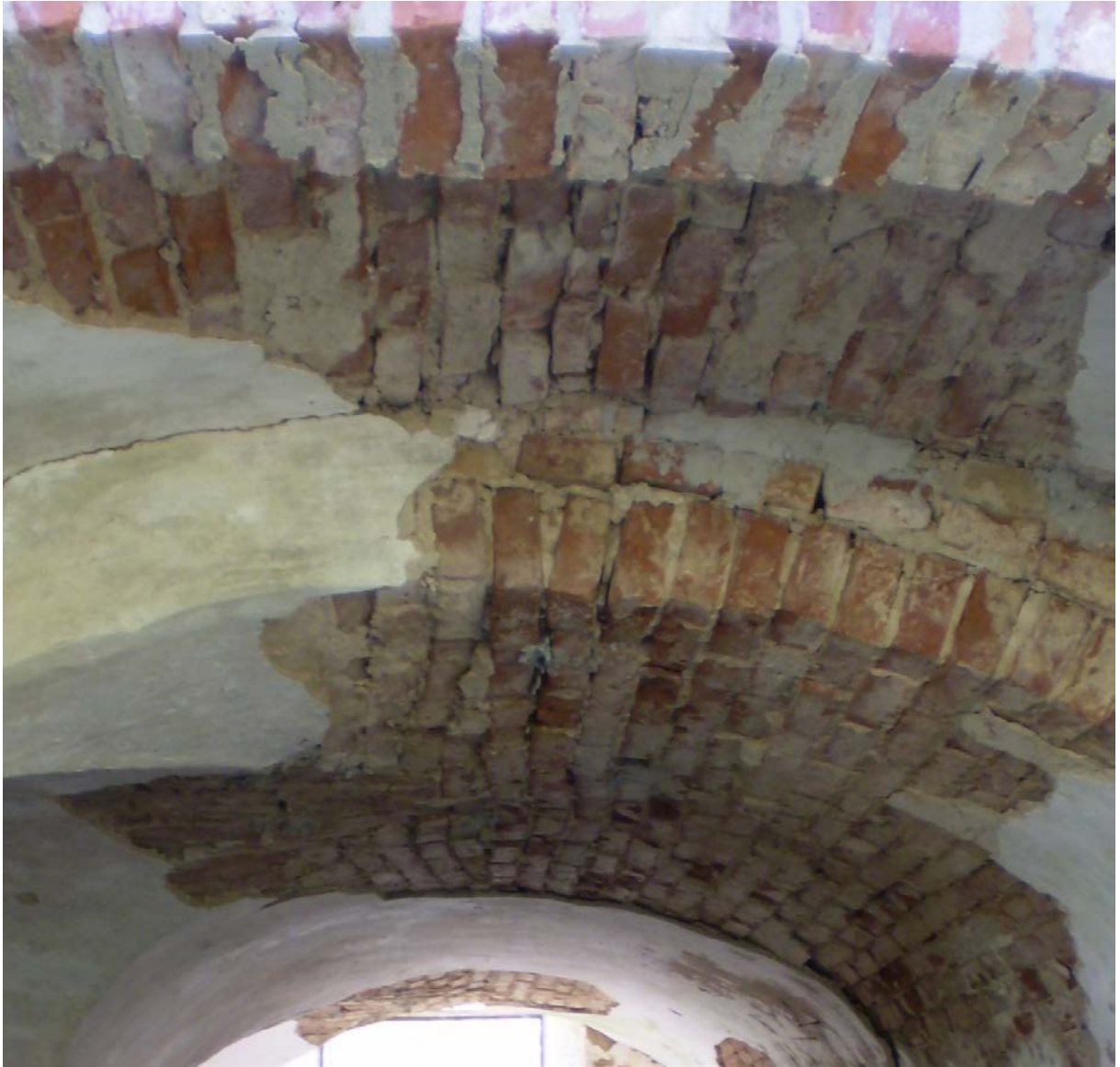
Foto 24 Võlvlae kahjustused tiibhoone keldris 2008.a.
