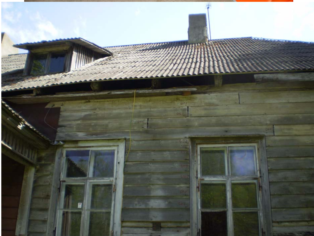
Foto nr.55 Kahjustunud räästakarniis härrastemaja loodeküljel 2008.a.
