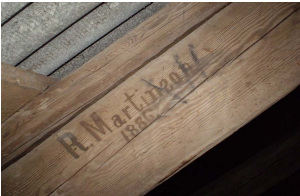
Foto nr.5 Dateering 1886a. härrastemaja loodekülje katusekonstruktsioonil.
