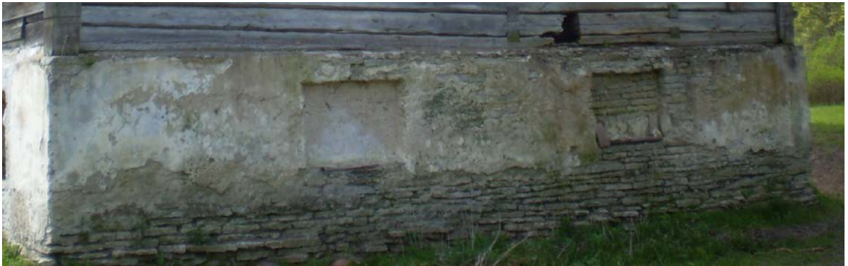
Foto nr.23 Vundamendi kahjustused tiibhoone kaguküljel.
