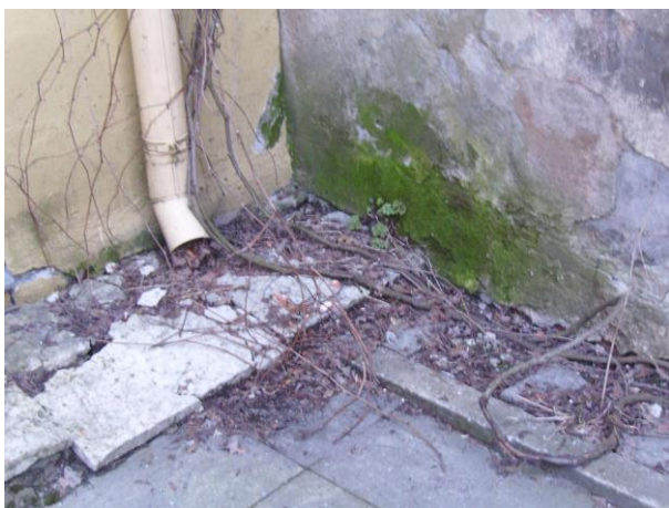
Pilt 5 Korrapidamata sadevee äravool
