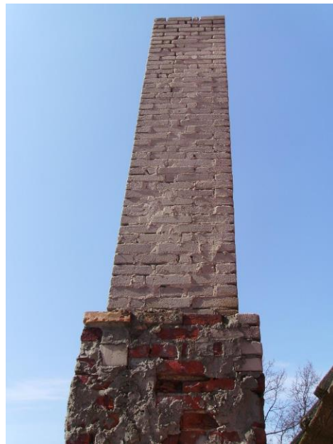
Pilt 21 Avariiline korsten
