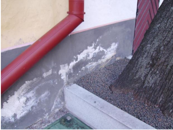
Pilt 7 Soolad esifassadi sokklil
