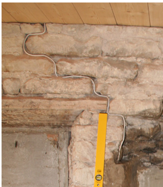
Foto 71 Elektrijuhtmed paekiviseina vuukides
