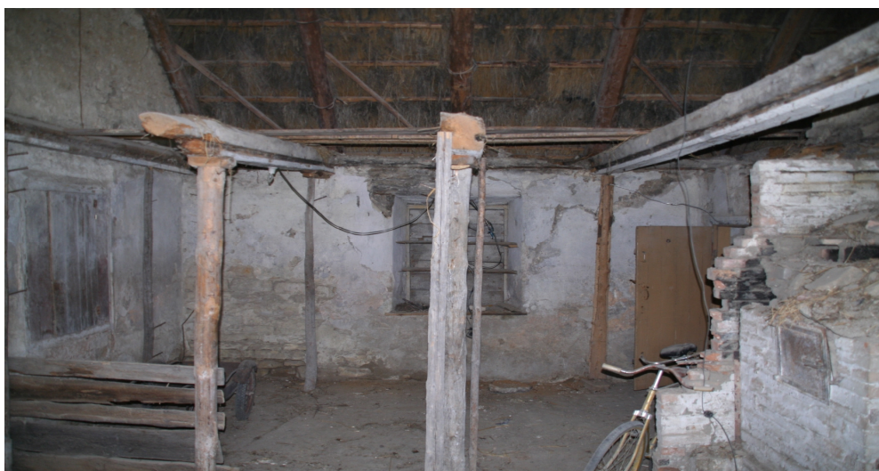
Foto 16 Paremäl näha lagununud leivaahi, mis ehitustööde käigus 2006 välja lammutatakse. Vasakul kapp-panipaigaks ehitatud kinnimüüritud otsauks. Lammutatud on vaheseinad, läbisaetud talade alla pandud toed.
