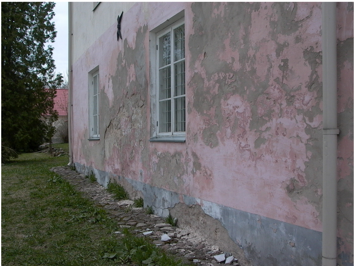
Joonis 18 Nurgasektsiooni soola- ja niiskuskahjustustega fassaad hoone välisküljel
