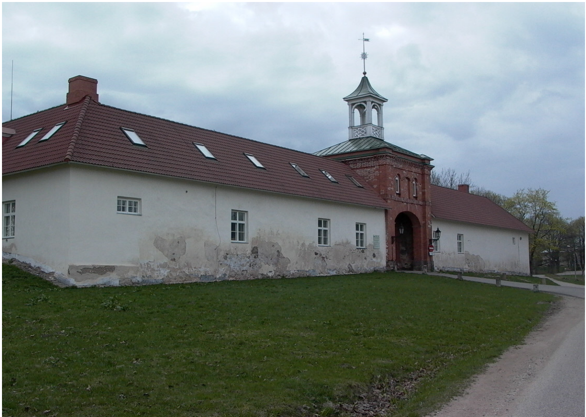
Joonis 23 Väravatorni vasaku ja paremapoolse hooneosa soola- ja niiskuskahjustustega fassaad mõisa välisküljel
