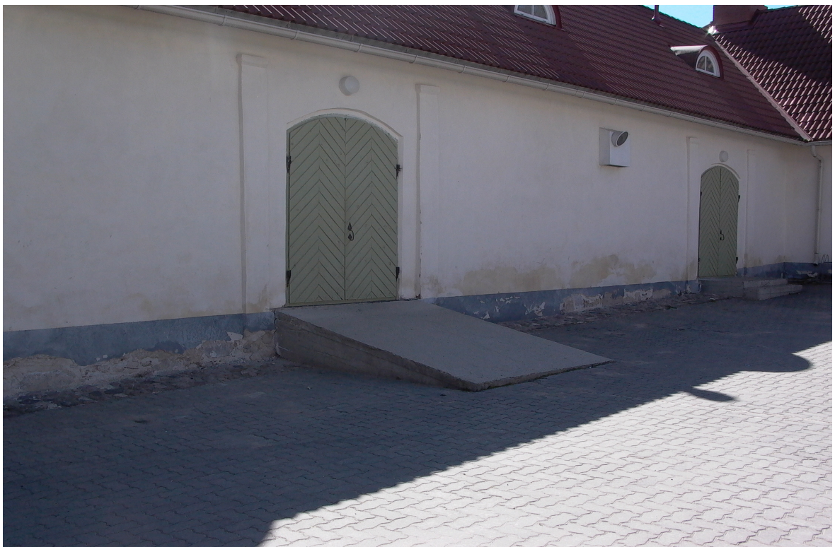
Joonis 26 Väravatorni vasakpoolse hooneosa soola- ja niiskuskahjustustega fassaad hoovipoolses küljes Foto aastast 2005
