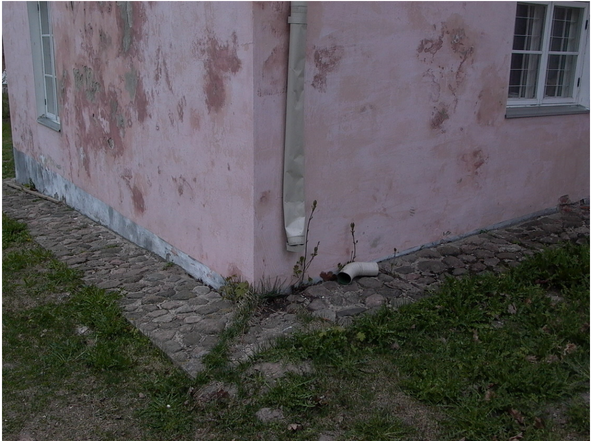
Joonis 20 Nurgasektsiooni lõhutud vihmaveetoru
