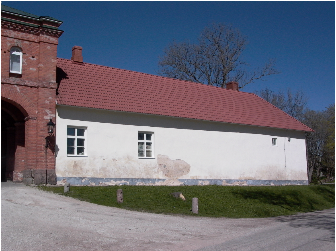
Joonis 25 Väravatorni parempoolse hooneosa soola- ja niiskuskahjustustega fassaad mõisa välisküljel. Foto aastast 2005
