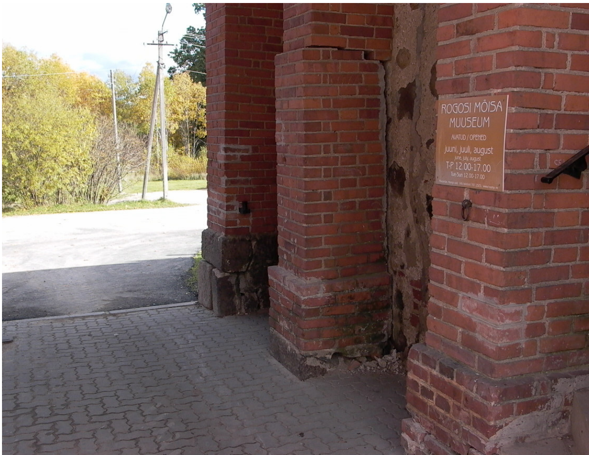
Joonis 29 Väravatorni võlvi äravajunud post
