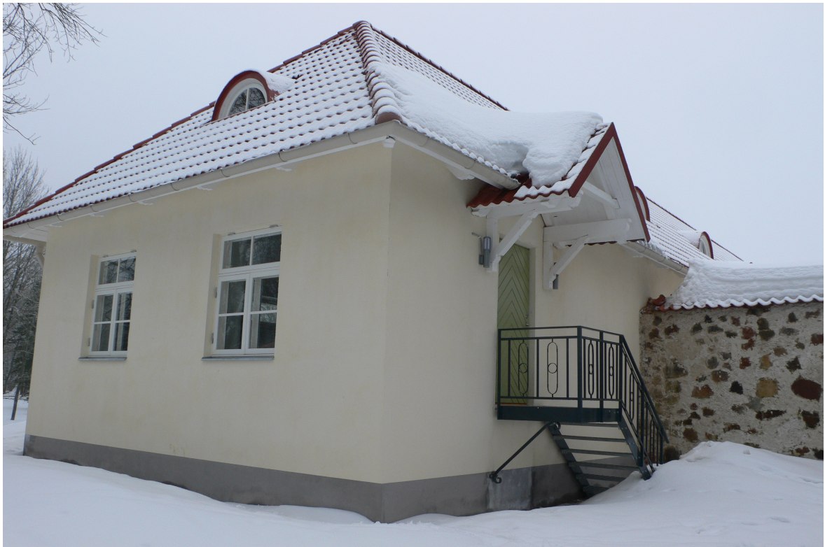
Joonis 34 Parempoolsel tiibhoonel trepi all näha kergeid soolakahjustusi
