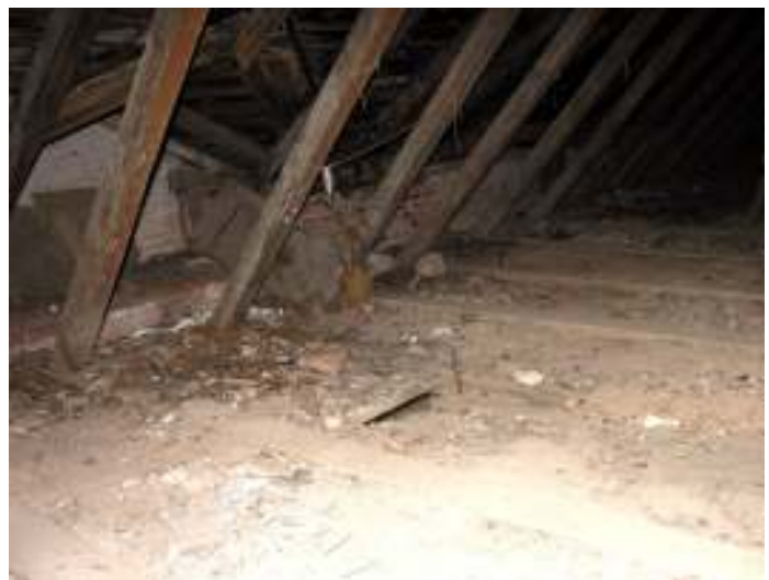
Joon 121. Vahelae ja katusekonstruktsiooni nähtavad kahjustused
