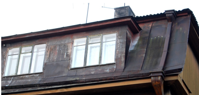
Joonis 17. Mansardkorruse plekist kattega vintskapp
