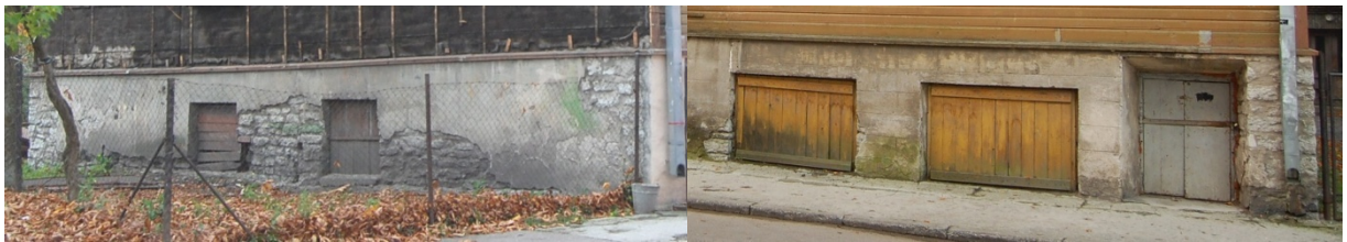
Joonis 3. Murenenud soklikrohv
