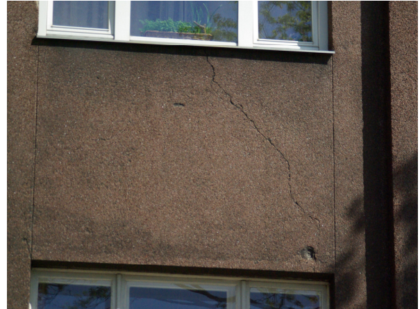
Joonis 22 Fassaadi pragu Autori foto 2010
