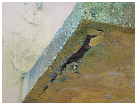
Joonis 18 Rõdukonstruktsiooni kahjustus Autori foto 2010
