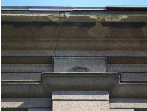
Joonis 21 Karniisi kahjustus Autori foto 2010
