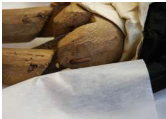
37. Metalli korrosioon ning puidukahjustused.
