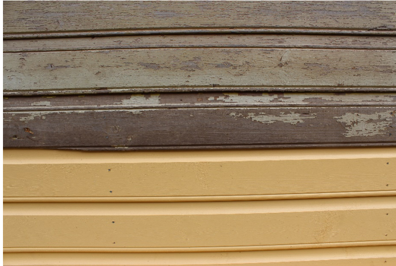
Foto 25 Tagumise fassaadi alumine serv – originaallaudis kõrvuti uuega.
