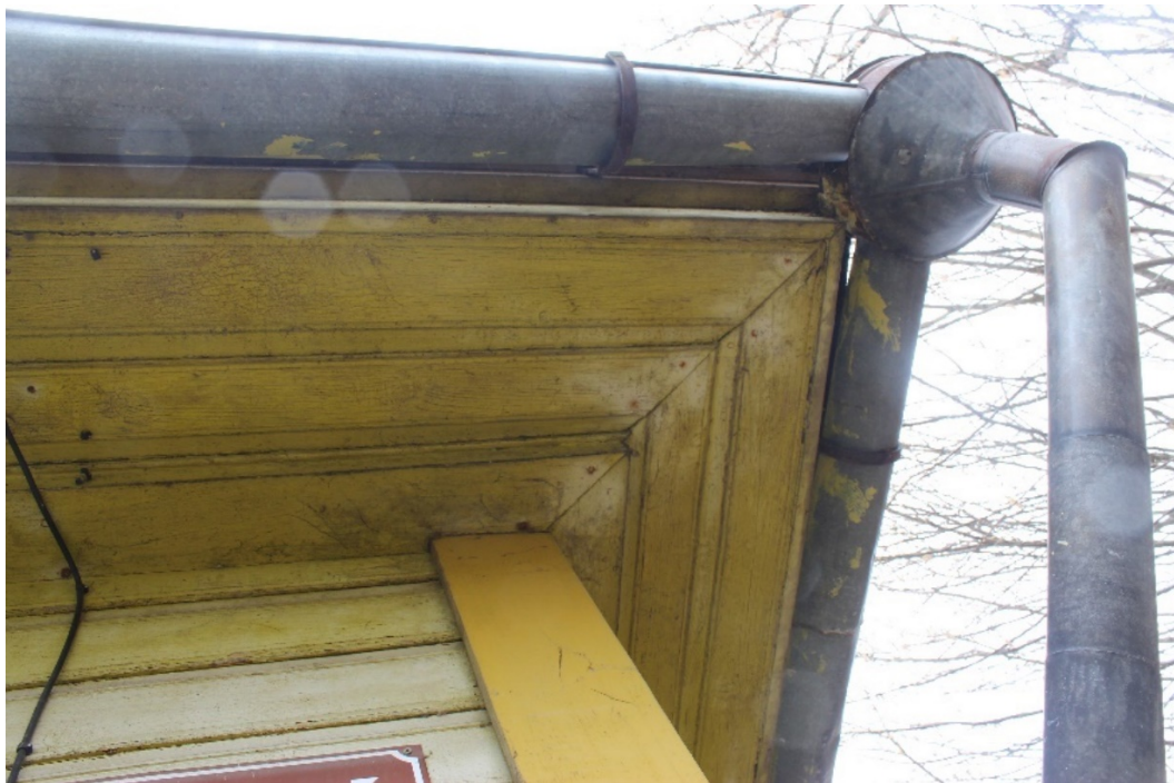
Foto 51 Kinnine tuulekast ja vihmaveesüsteem.
