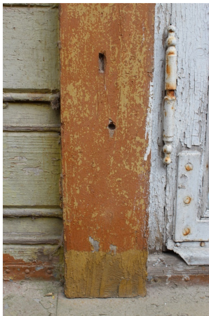
Foto 33 Osadel aknapiirdelaudadel kõige viimane värvikiht roostepruun.
