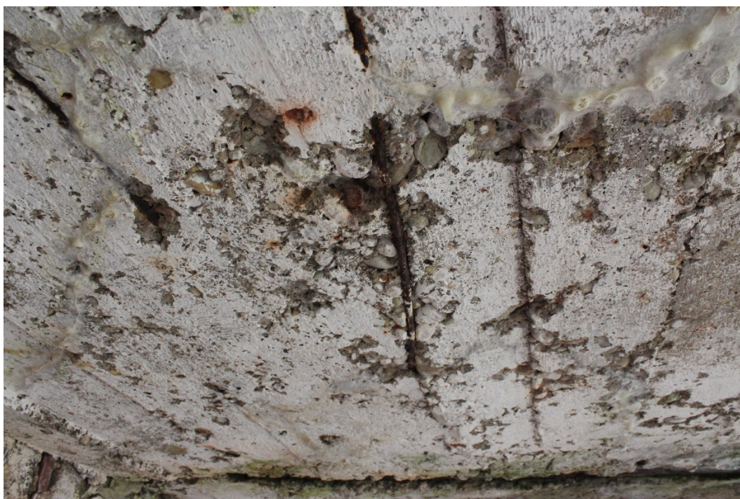
Foto 21 Terrassialuse raudbetoon lae paljastunud sarrused, hallitus.
