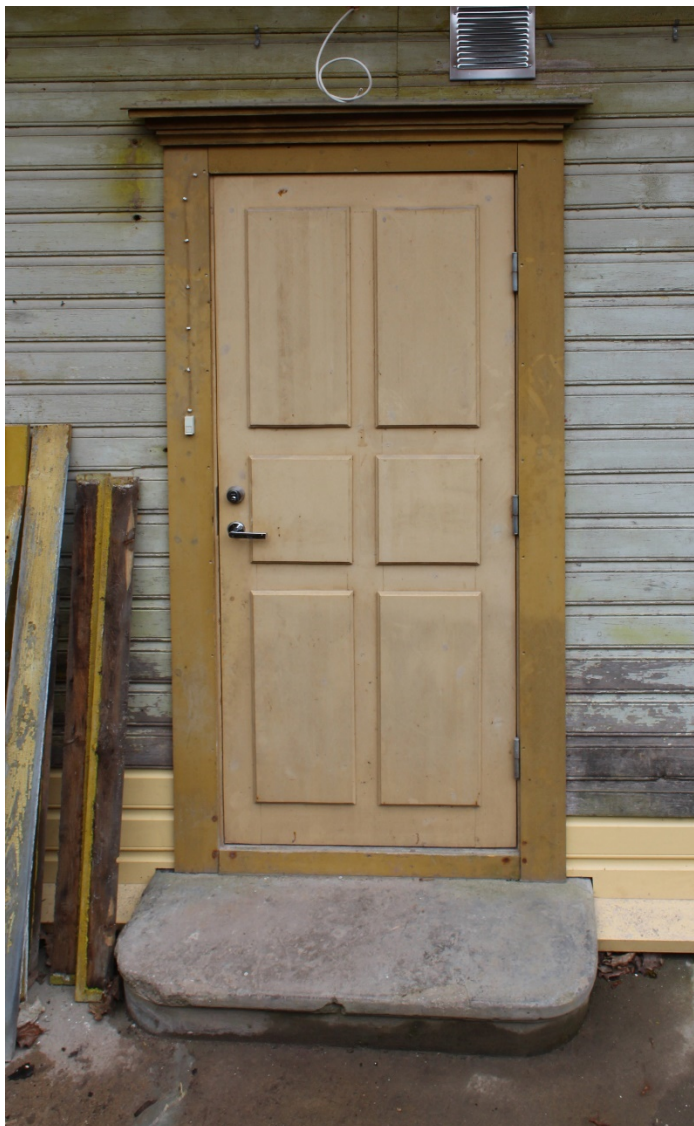
Foto 61 Oru 21 poone tagumine uus välisuks.
