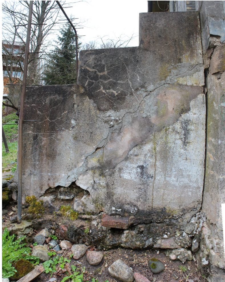
Foto 96 Ebaõnnestunult parandatud pragu trepi betoonpiirdes.
