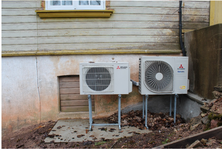
Foto 12 Õhk-õhk soojuspumpade välised agregaadid peatrepi kõrval.
