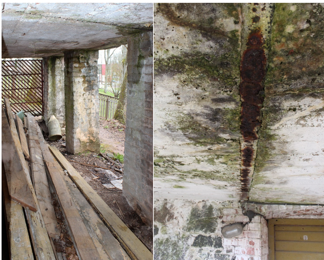
Foto 20 Tõstetud terrassi alune, roostekahjustustega terrassi kandetala.
