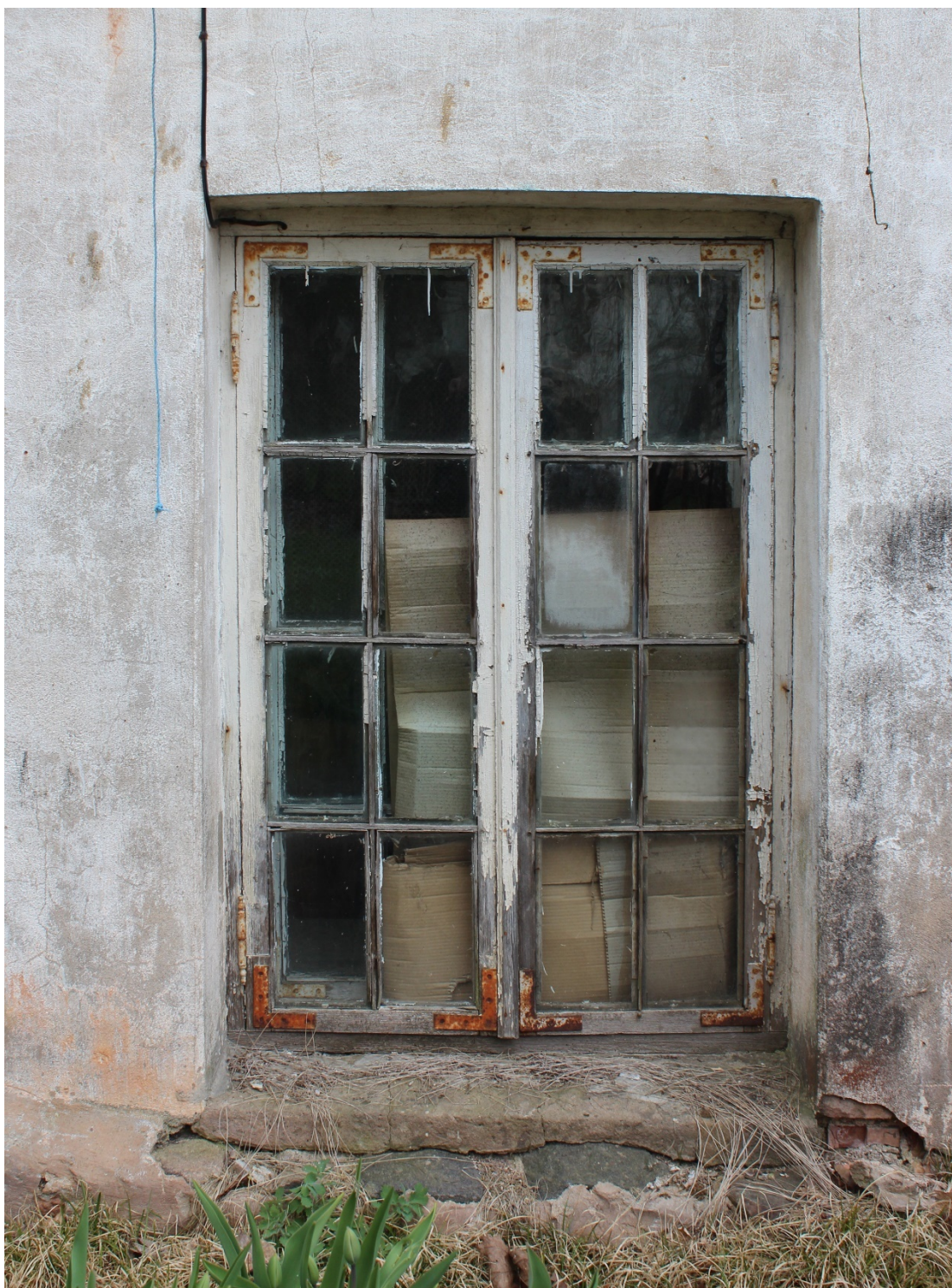
Foto 92 Keldri väga halvas korras 16 jaotusega aknad.
