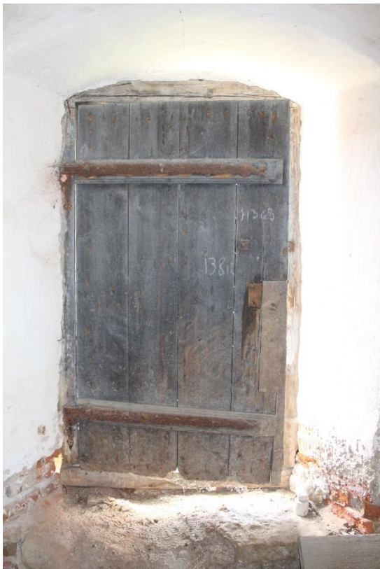
Foto 25, 26 ja 27. Kabeli ukse leng, uks väljast ja seest 28.04.2021.
