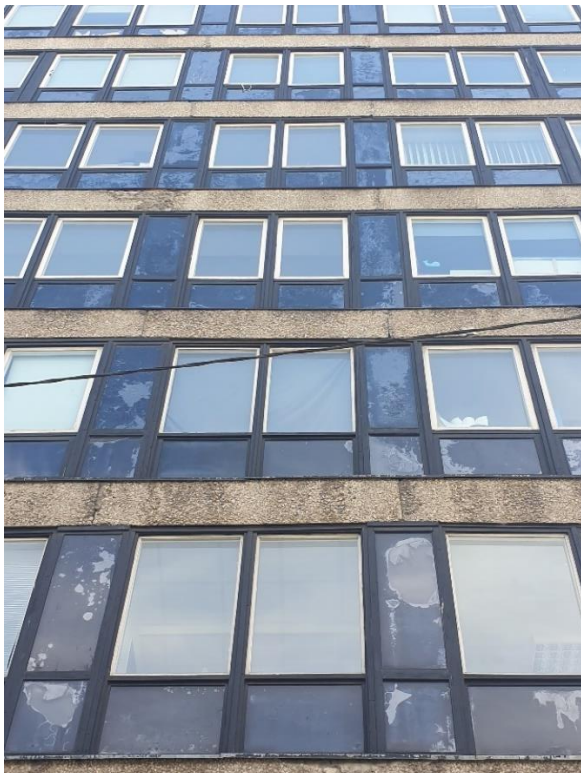
III 14. Fassaadi värvitud klaaside kahjustused.
