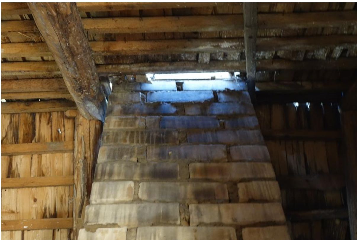
16. Katuse kahjustus korstna ümbruses
