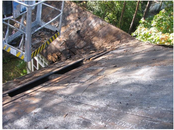
III.34 Veranda ja maja ühendusnurk. See koht on saanud tugevaid vee ja granaadiplahvatuse (?) kahjustusi.
