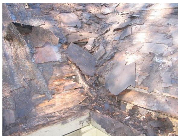
III.32 Veest ja veel millestki kahjustunud veranda ning maja nurk. Kohati on kasutatud katuse paikamiseks plekki.
