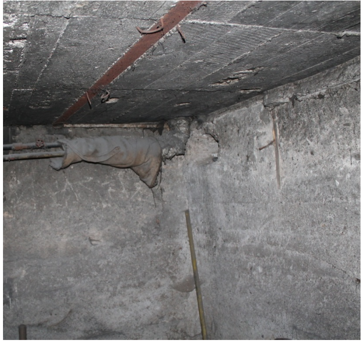
Foto 8. Vaade keldris. Seintel ja laes on näha laudise jälgi
