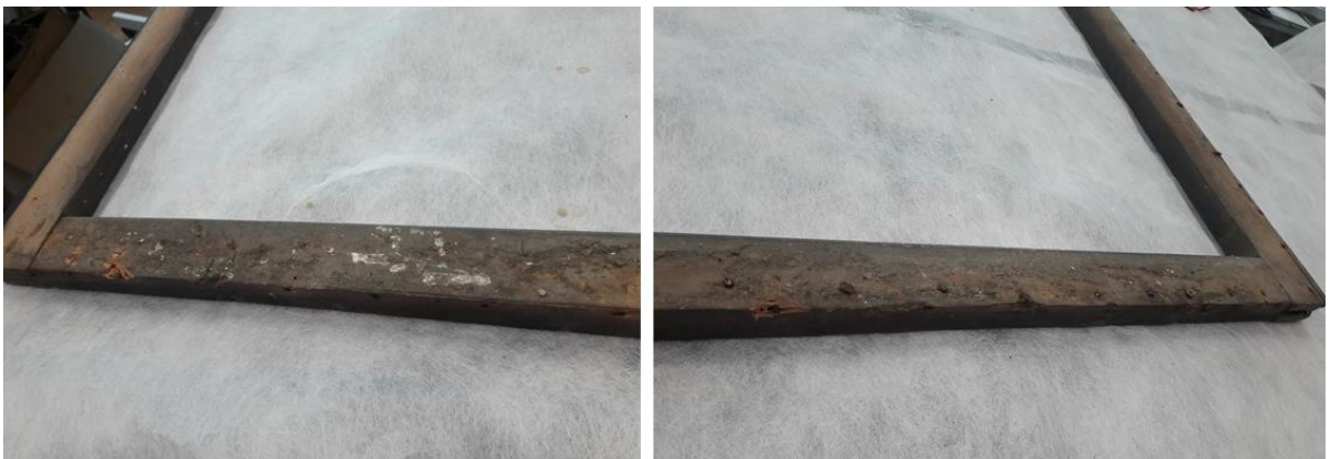
Joonis 68. Maali alusraami kattis paks akumulunud tolmuhiht.
