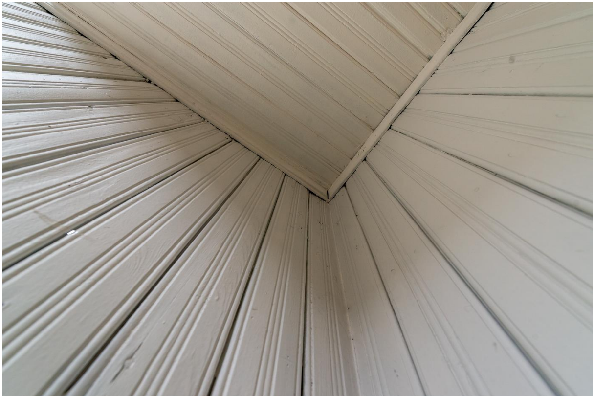
Illustratsioon 27. Tehnika 7, tagumise trepikoja lagi ja sein. Foto Margus Vilisoo 23. aprill 2018.a.
