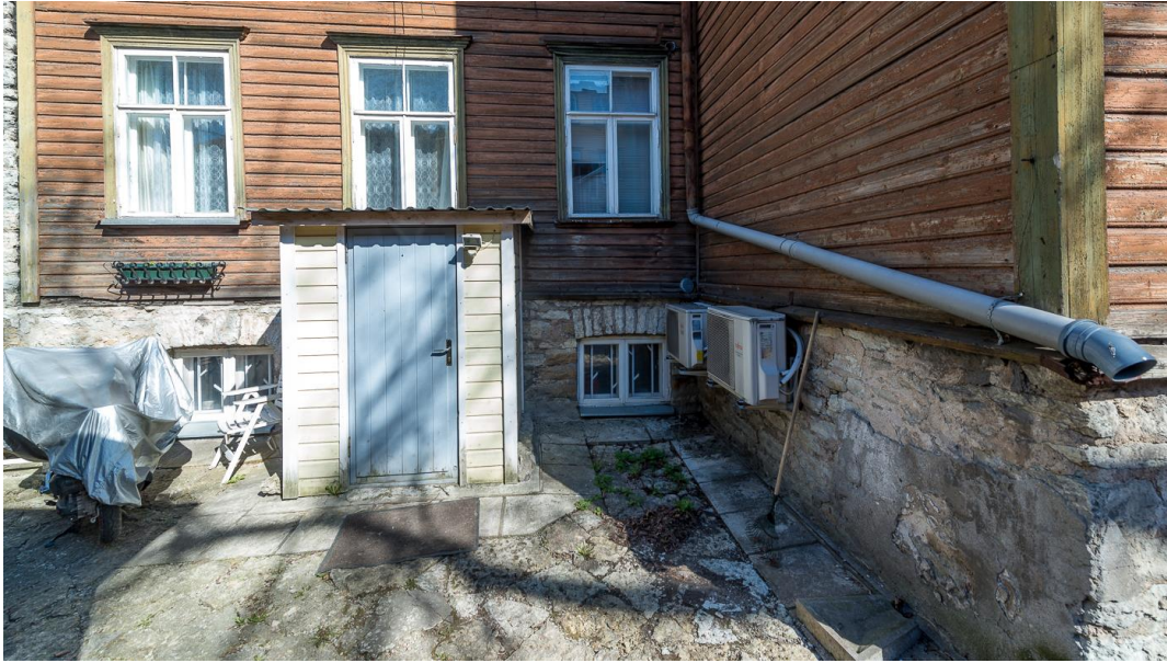
Illustratsioon 53. Tehnika 7, Tagumine keldrisse sissepääs ehitada ringi. Foto Margus Vilisoo 23. aprill 2018.a.
