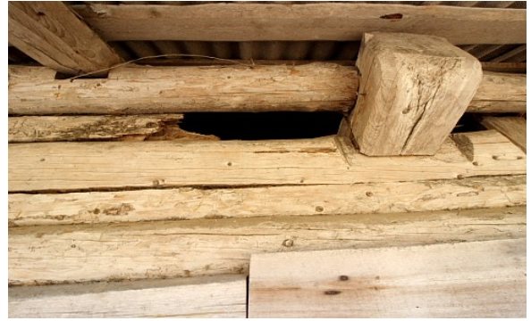
27. Kahjustunud ülemise rea palk
