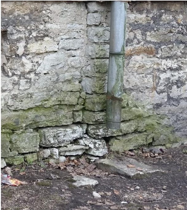
14. Niiskuskahjustus ja tsementkrohviga teostatud parandused sokliosas
