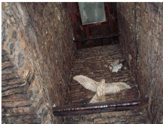
31. Tõlluste mõisa aednikumaja mantelkorsten, ventilatsioon. Pihla vald.
