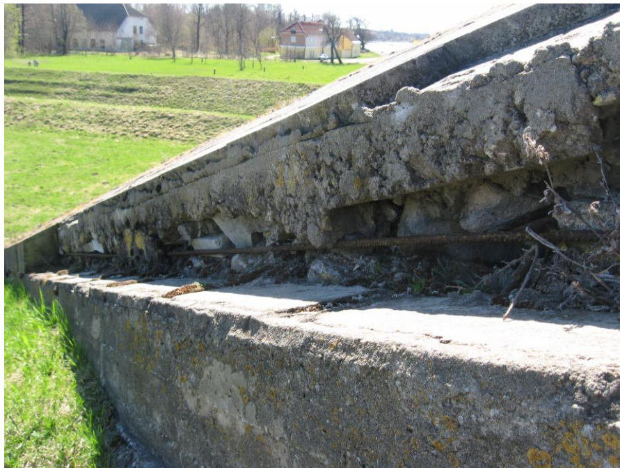
43. Püramiidi konstruktsioon – puudevate paeplaatide alt paljandub metallkarkass.
