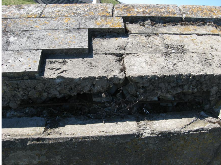
44. Püramiidi konstruktsioon – puudevate paeplaatide alt paljandub metallkarkass.
