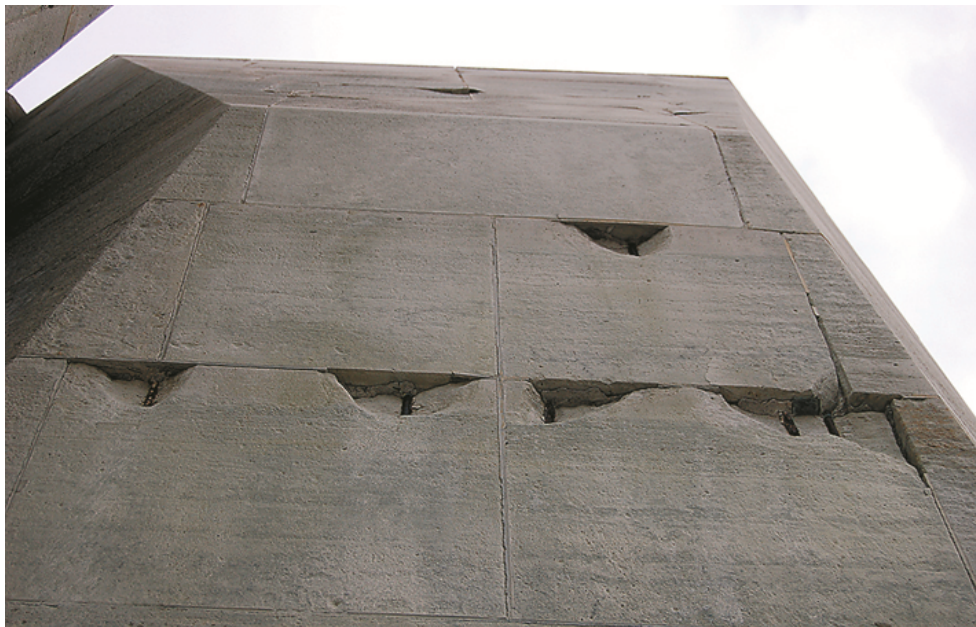
6. „Igavese tule“ dolomiitkatte alt paljanduv metallkarkass.
