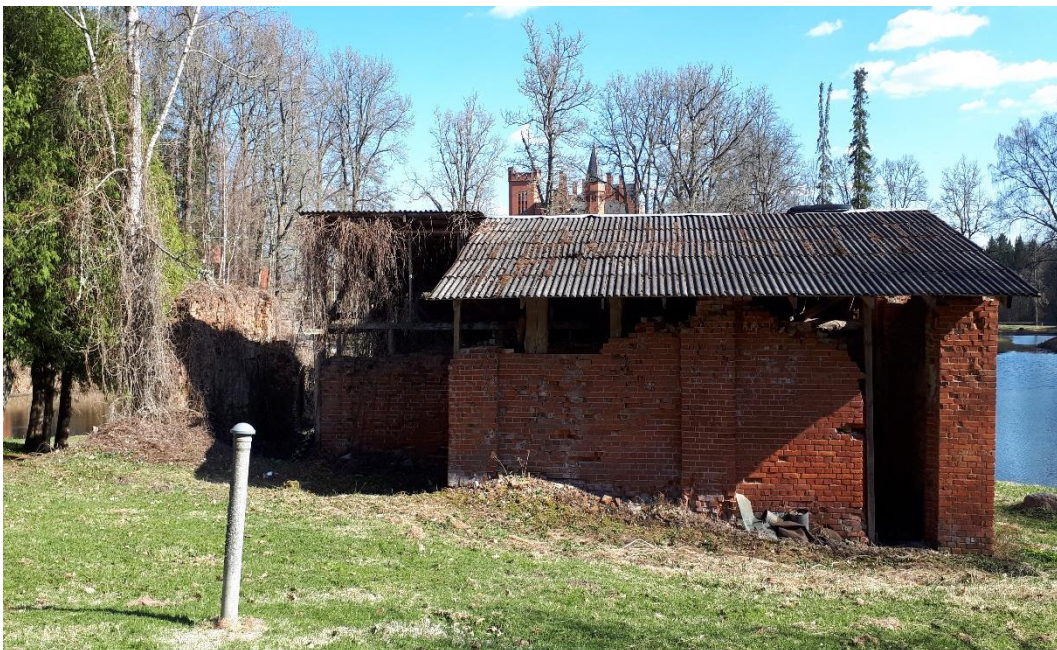
14. Vaade tagafassaadile loodest. Seina ülemine osa ja karniis puuduvad
