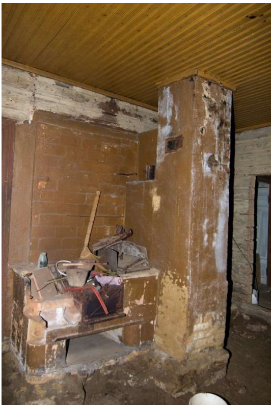
Foto nr 12. Puupliit köögis ning taastamist vajav korsten
