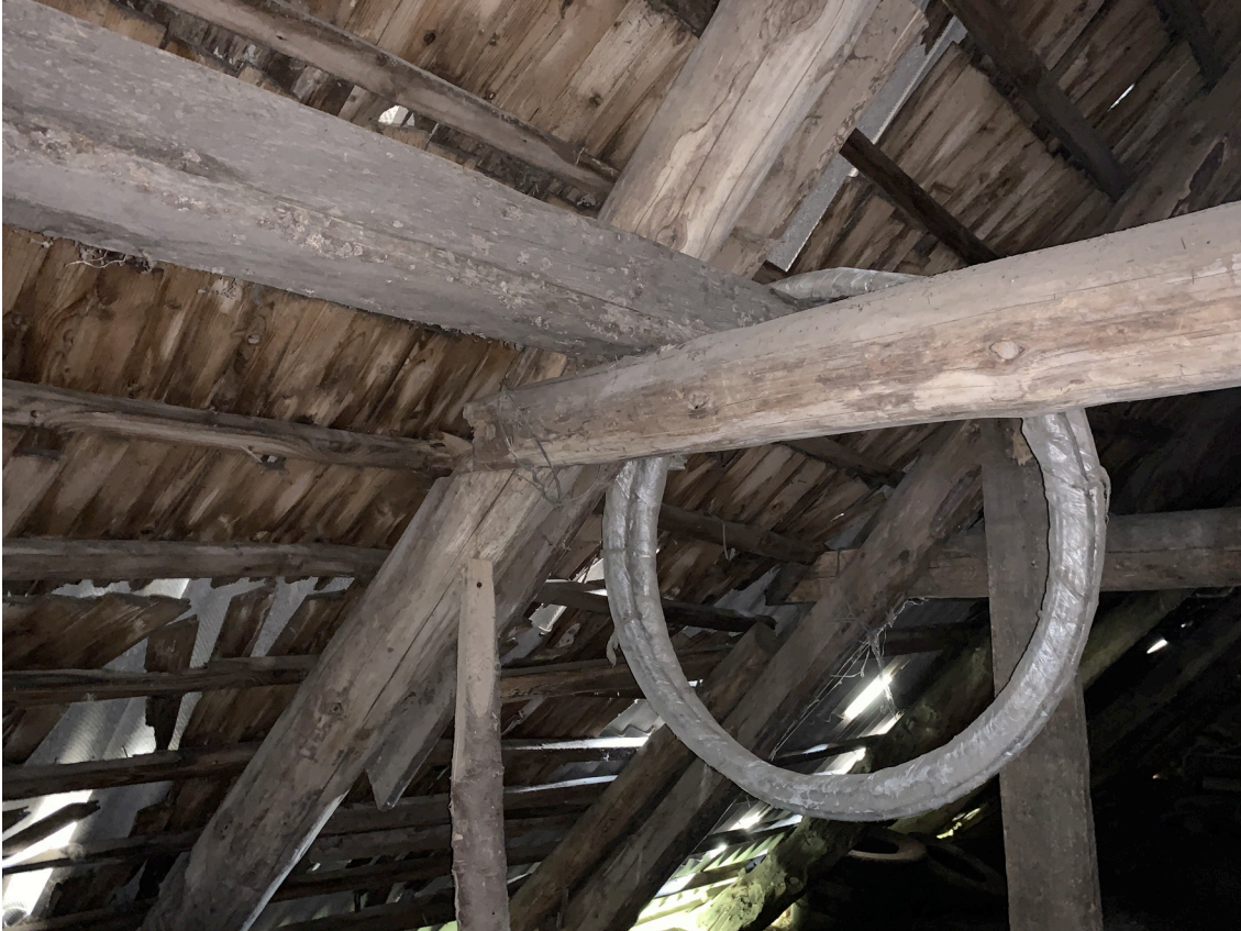
12. Aidahoone, eterniidi all säilinud laastud, katusekatte seisukord, aprill 2019
