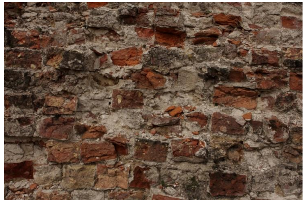
10. Liiga tugeva mördiga vuugitud tellised Otepääl.
