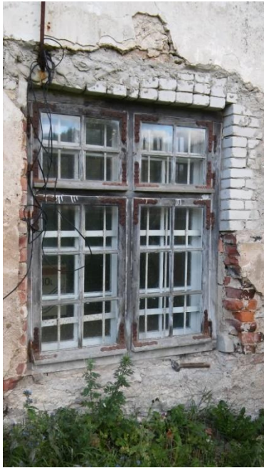
48. Aken idafassaadil, silluse asemel silikaat. Trellid.
