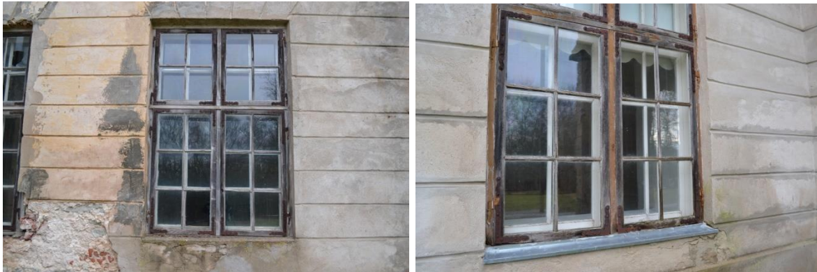
49. Esimese korruse läänefassaadi aknad, osa veeplekkidega.
