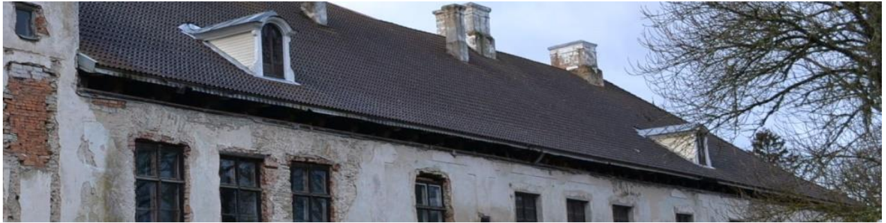
42. Idafassaadil puuduvad rennid ja torud.
