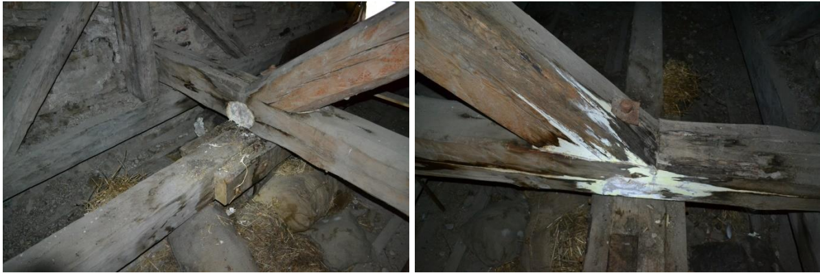
163. Seenkahjustus lõunapoolse risaliidi plekk-katuse ja kivikatuse liitekohta all.
