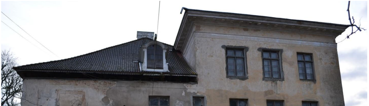
43. Põhjafassaadil vasakul rennid puuduvad, paremal nurkades veesülitid.
