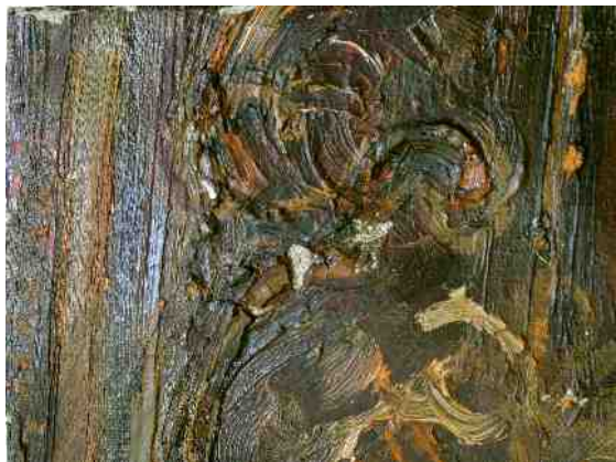
Maalikihi kahjustus töö vasakul ülaosas.
