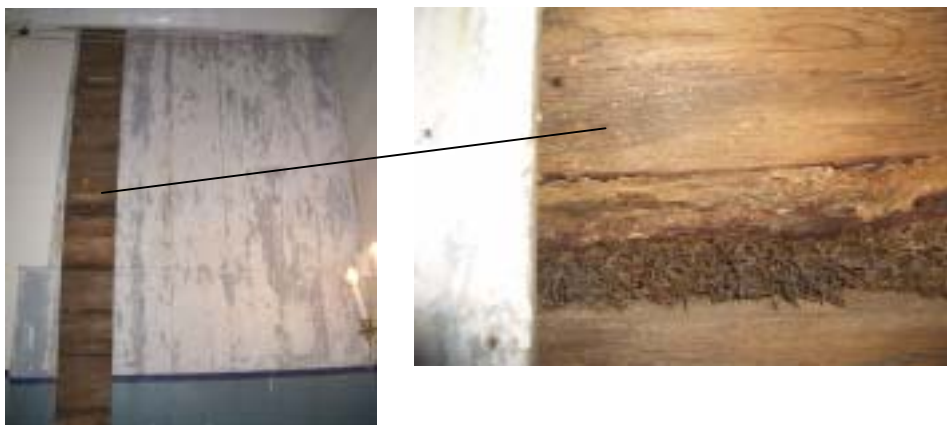
Putukkahjustused kirikuhoone põhjaseina palkidel.
