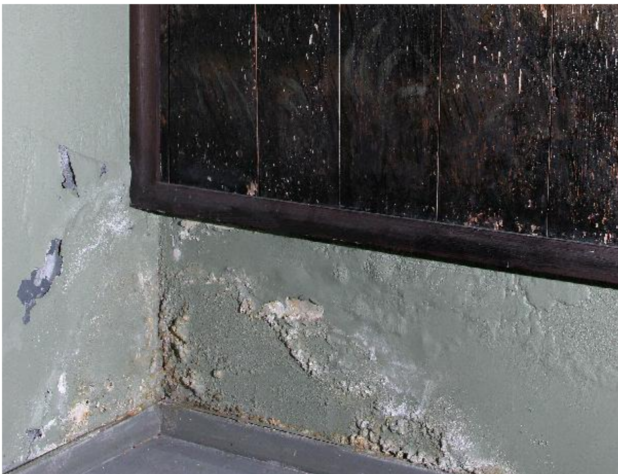
Pilt 3. I korruse vastuvõturuumi maaliniši vasak alumine nurk soolakahjustustega
