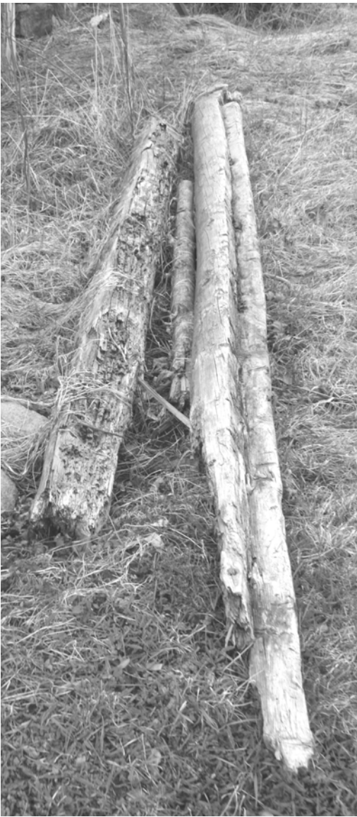
Foto 5.7.7. Pritsu talu ait. Alumised pehkinud palgid on konstruktsioonist eraldatud. Valtsiga palgist on tehtud täpne koopia, mis läbi edaspidiste säilitamistöödega on arvestatud – hoonele iseloomulik lahendus on säilinud. Konstruktsioonist eemaldatud palgid on hävitatud, iseloomulikke detaile ei ole arhiveeritud.
