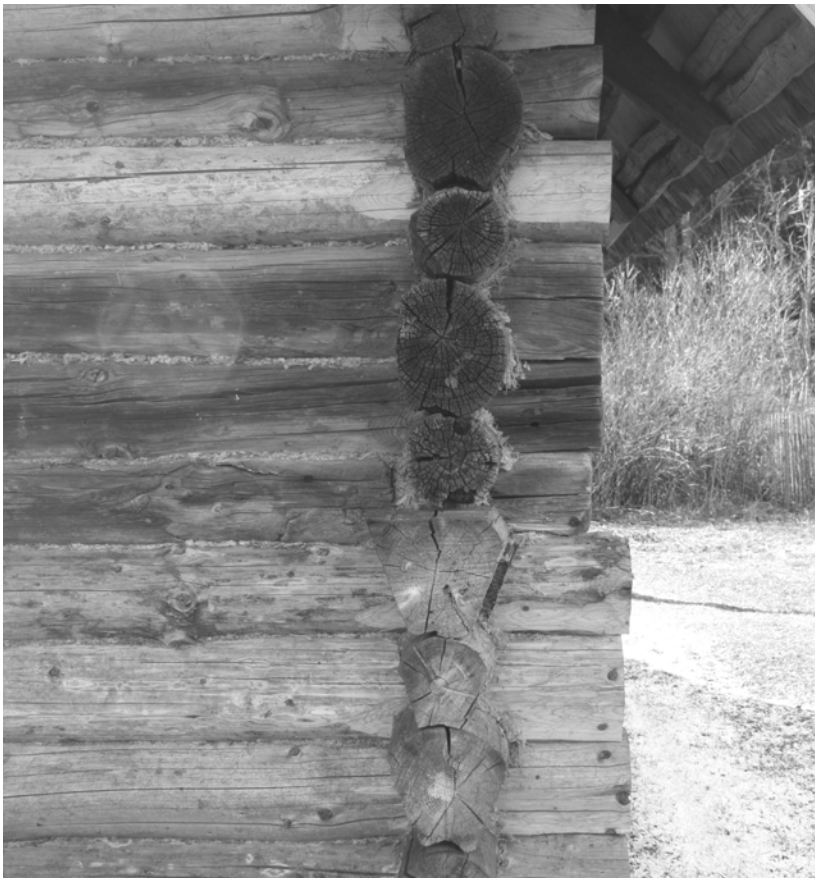
Foto 5.7.1.6.1. Sepa talu rehielamu rehealuse kirdenurk: asenduspalkidel on algse eeskujul lahtine vara
