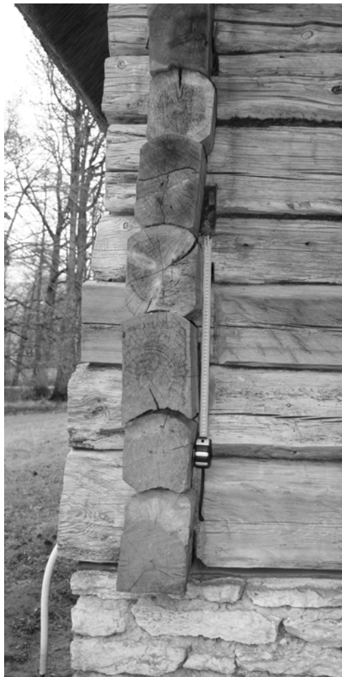
Foto 5.7.8. Sutlepa kabeli loodenurk (nurk AB). Rekonstruktsioonis on algsed palgid hävitatud. Uued palgid ei ole algsete koopiad vaid põhimõtteliselt sarnaselt lahendatud. Algmaterjali häving ning konstruktsiooni uus lahendamine ei arvesta tuleviku säilitamistöödega. Vanemaid iseloomulikke osasid ei ole arhiveeritud.
