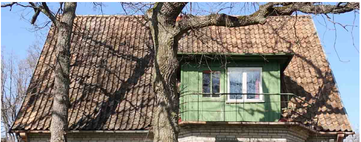
Illustratsioon nr 20. Vaade hoone katusele Paju tn poolt. Katusekivide tehniline seisukord on rahuldav. Kividel esineb sammalt, kuid kõik harjakivid ja S-katusekivid on omal kohal ja terved. Autori foto 18.04.2020
