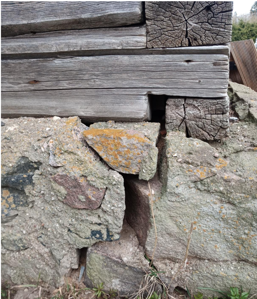
Foto 20 Eeskoja kahjustunud soklinurk edelast vaadatuna
