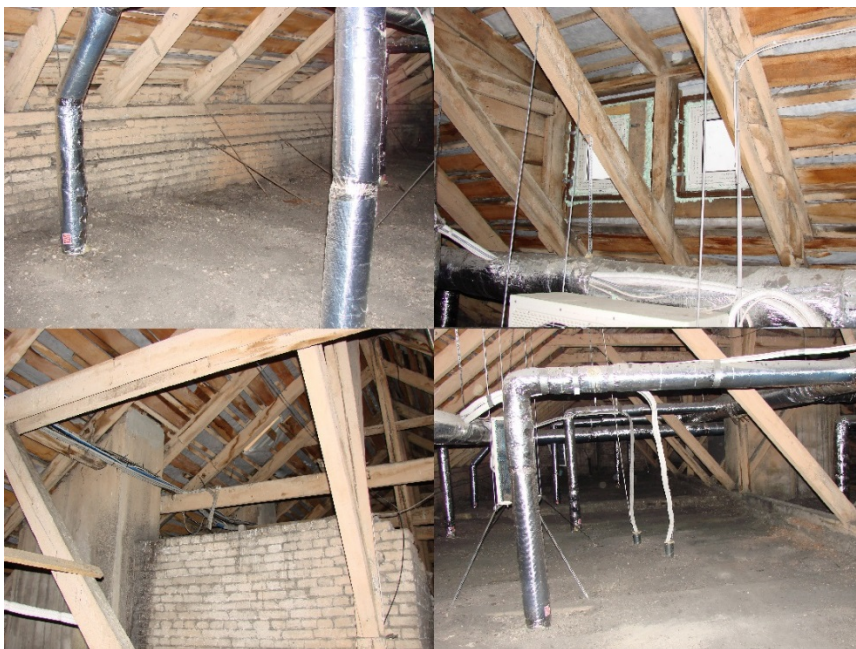
Jn 22. Katuse pööning. Allikas: Dekoraator OÜ „Peetri pl. 3 hoone tehnilise seisukorra eksperdi aruanne“ 2009. Narva
