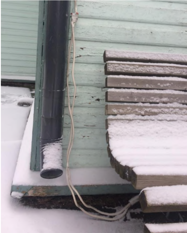
Hoone sissepääsu kõrval ripnevad jätkatud voolujuhtmed. Autori foto 26.02.2020
