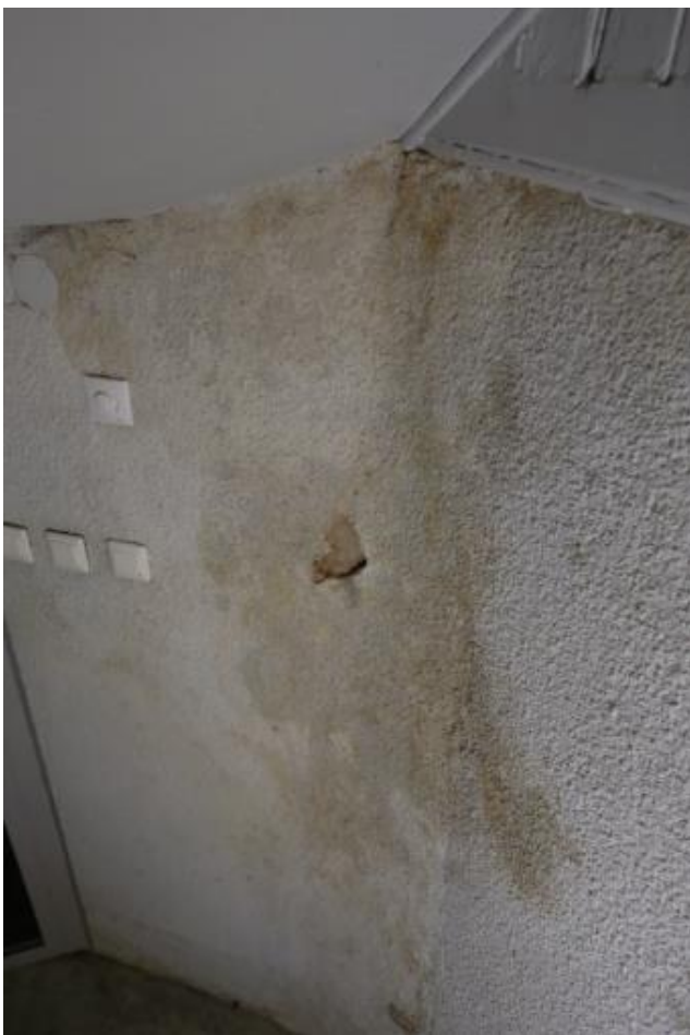
Foto: vaade keldrile ( vana hoone alune osa), niiskusest kahjustunud krohv. Autor P.Pihlamäe 2019
