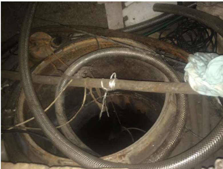
Foto: keldrisse on kaevatud 2 kaevu, millele paigaldatud anduriga pump. A:P.Pihlamäe 2019
