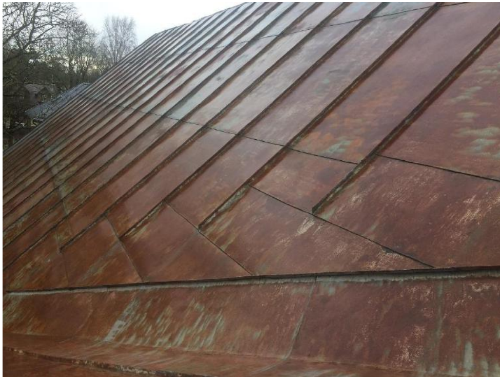
Foto, Vana valtsplekk katus on korrodeerunud. Autori foto 20.02.2020
