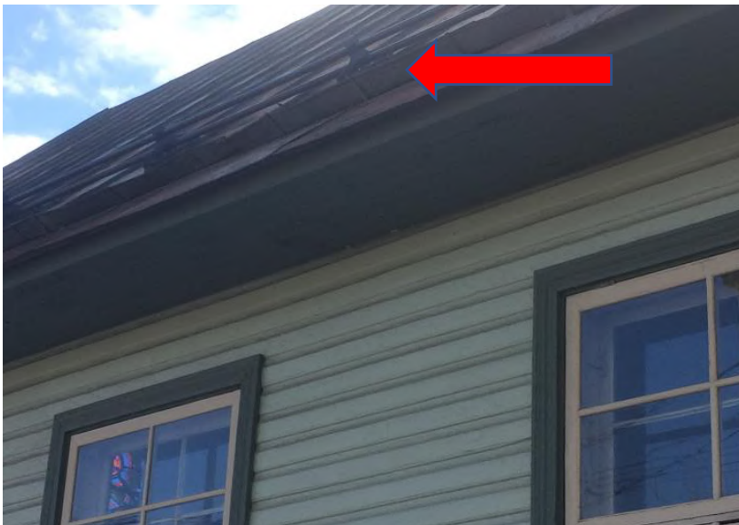
Foto, vaade hoonele põhjapoolsest nurgast. Vihmaveerenn on alla vajunud, lumetõke on hiljem lisatud katusemeister Joel Vahermägi poolt. Autori foto 17.04.2020
