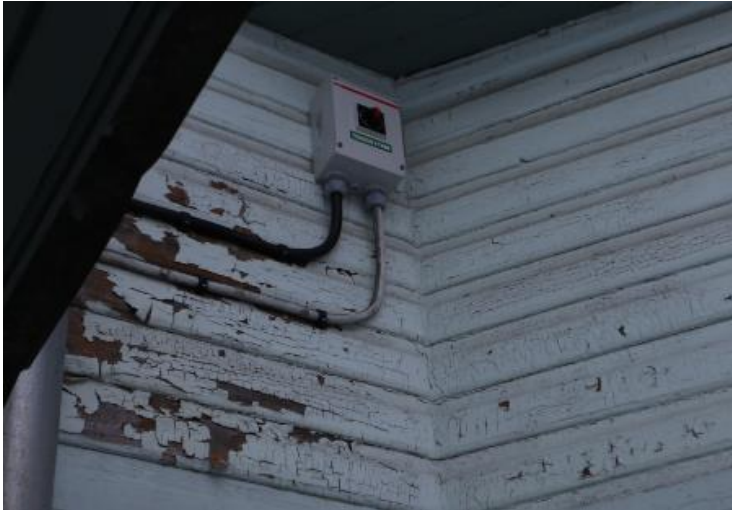
Foto: kaablid maja seintel on niiskuse kogujad. Autor: P.Pihlamäe
