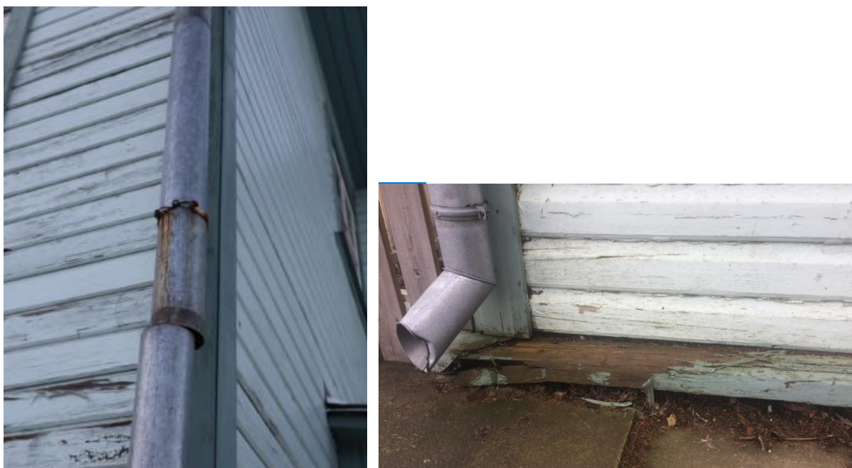
Foto: katkine vihmaveetoru ja niiskusekahjustusega veelaud. Autori fotod 20.02.2020
