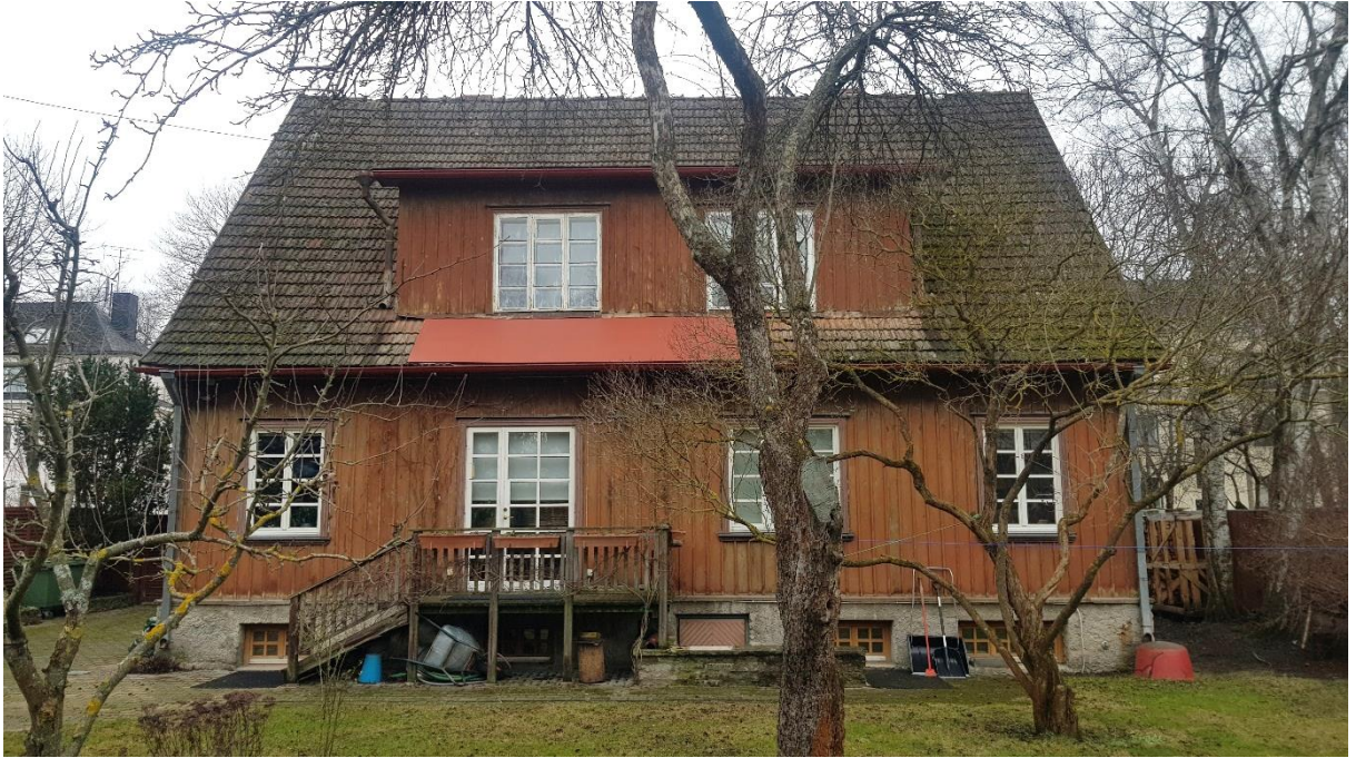
24. Vaade hoovi poolt. Avariilist katus on osaliselt kaetud punaka plaatmaterjaliga.
