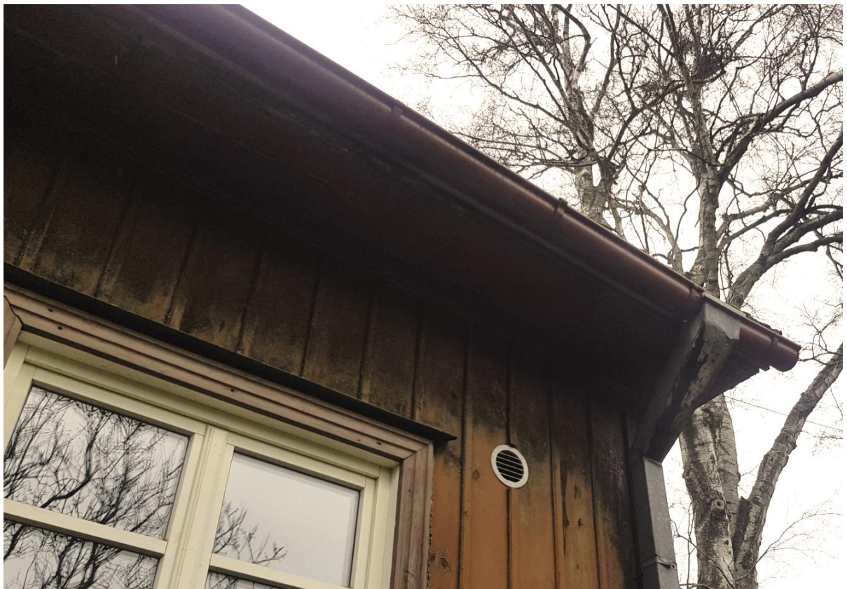
23. Voodrilaudise kahjustused räasta all ning vihmaveetoru ümbruses.
