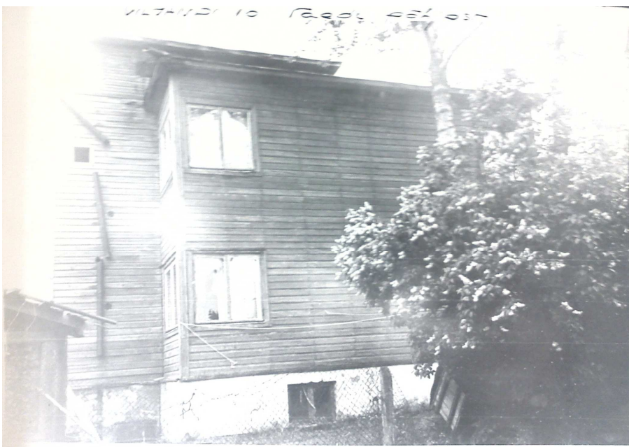
ill 30 Vaade põhjast maja tagaküljelt (Kalmistu tee poolt), näha on kuivkäimla kogumiskasti lagunenu õhutustoru.
