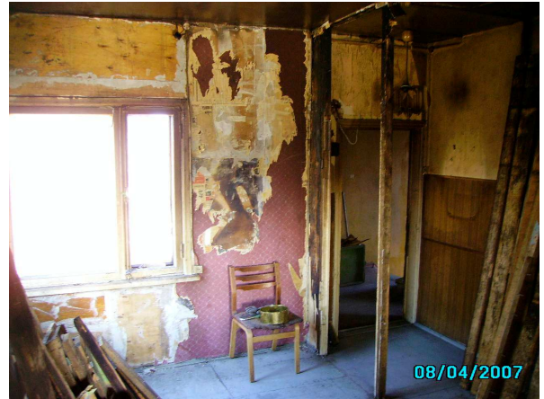
ill 51 kergete vaheseinte lammutamisel ilmnevad 1993 a tulekahju jäljed
