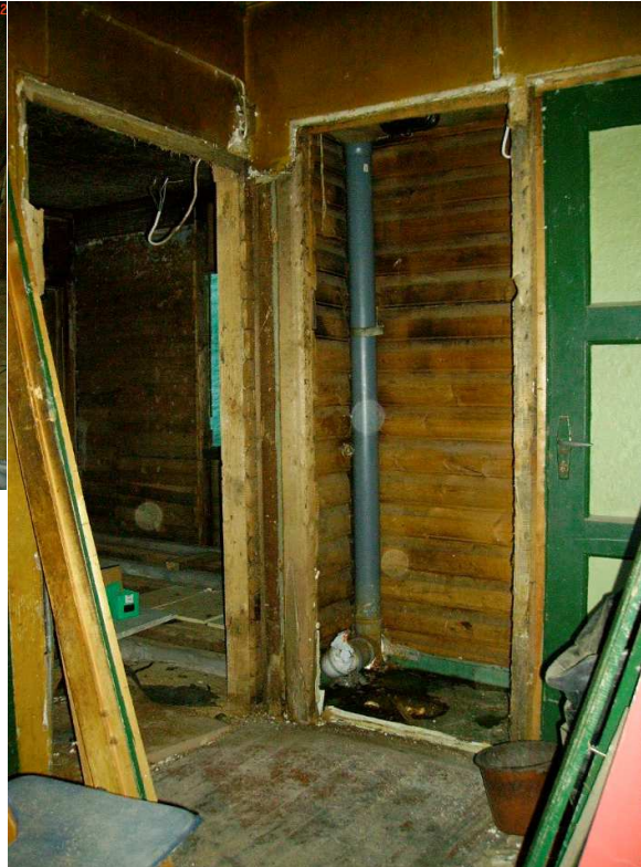
ill 76 Vaade teise korruse endisele wc-le. Põrand on ruumis täiesti mädanenud. Seda oligi oodata.
