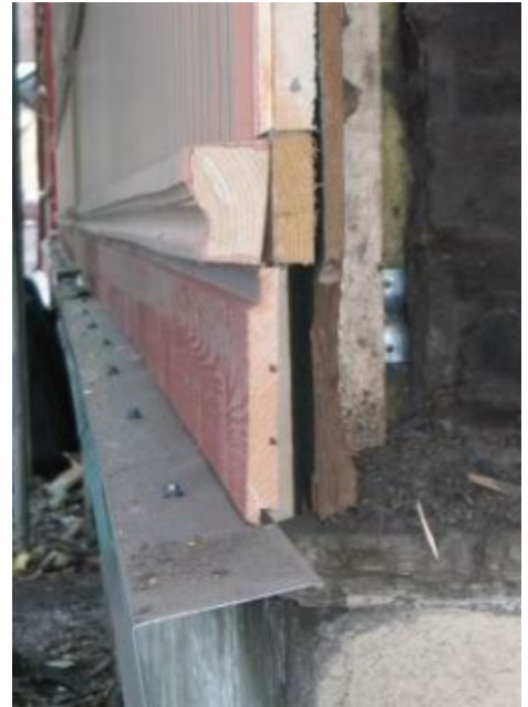
48. Vabriku 19 soklilaua, vertikaalse laudise ja karniisi ühendus näitab ilmekalt, et selline lahendus ei väldi vee fassaadilt konstruktsiooni sattumist.
