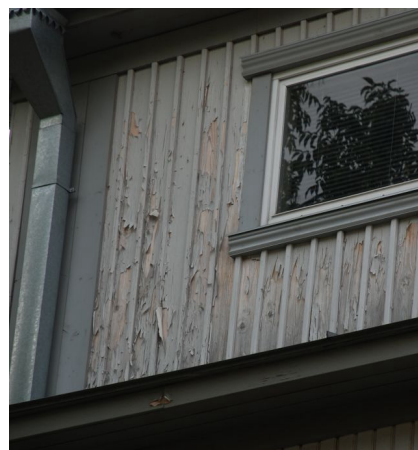
50. Ao tn 3 fassaad u 4 a pärast lateksvärviga värvimist. Foto: I. Martin, august 2007.
