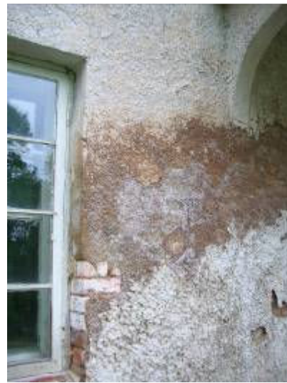
Joonis 4.30 Hoone kagupoolel küljel olevad lokaalsed kahjustunud pinnad, autori foto.
