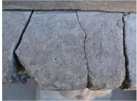
14. Sügavad praod läänepoolse samba baasi karniisil. Paljastunud eemaldatud varasema mördiparanduse pronksist tüüblid. 10. VII 2016.
