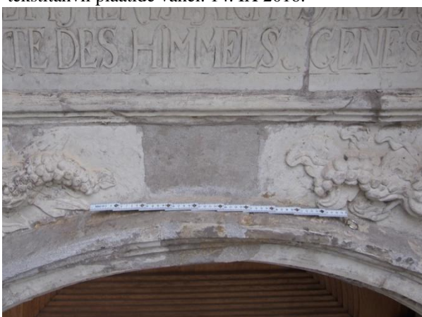
50. Kadunud lukukivi asendav silmatorkavalt vale tooniga varasem tsementplomm. 11. VII 2016.
