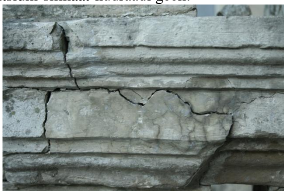
36. Niiskuskahjustusega väga kõva vesiklaasiga mördi parandus. 20. VII 2015.
