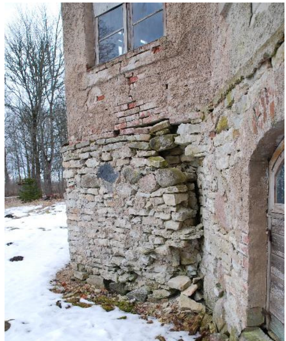
Foto 28. Pragu tagafassaadi eenduva osa sokli ühenduskohas.
