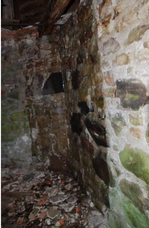
Foto 101. Veekahjustus ruumi 2 seinal.
